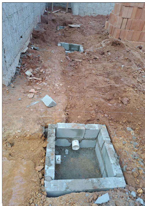
CAIXA DE PASSAGEM EM ALVENARIA
