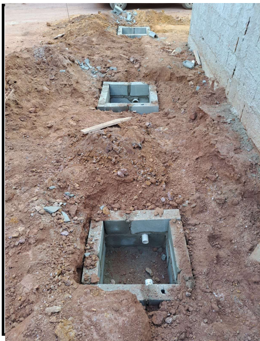
CAIXA DE PASSAGEM EM ALVENARIA
