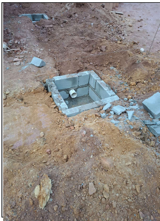
CAIXA DE PASSAGEM EM ALVENARIA
