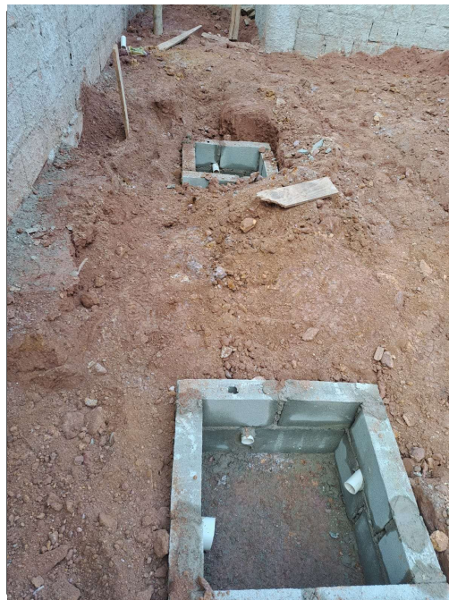
CAIXA DE PASSAGEM EM ALVENARIA
