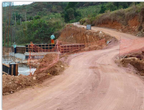
sinalização de segurança
