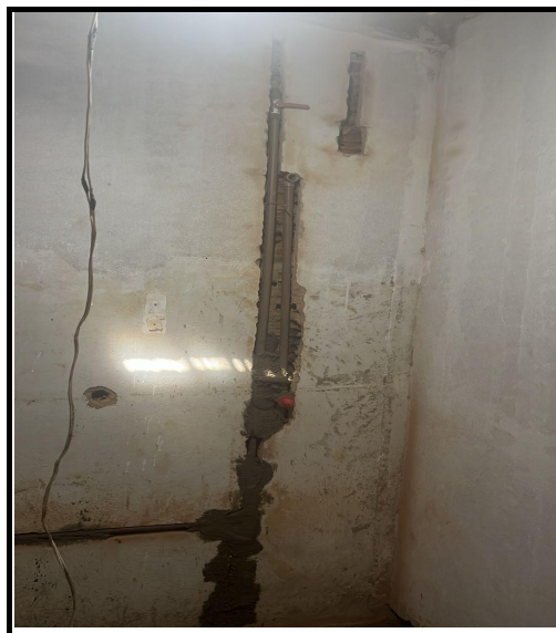
Figura 12 -tubo PVC e Registro de Gaveta e Pressão- Cozinha
