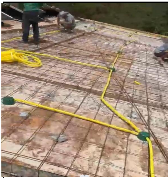
Figura 9 - Eletroduto corrugado e caixa octogonal
