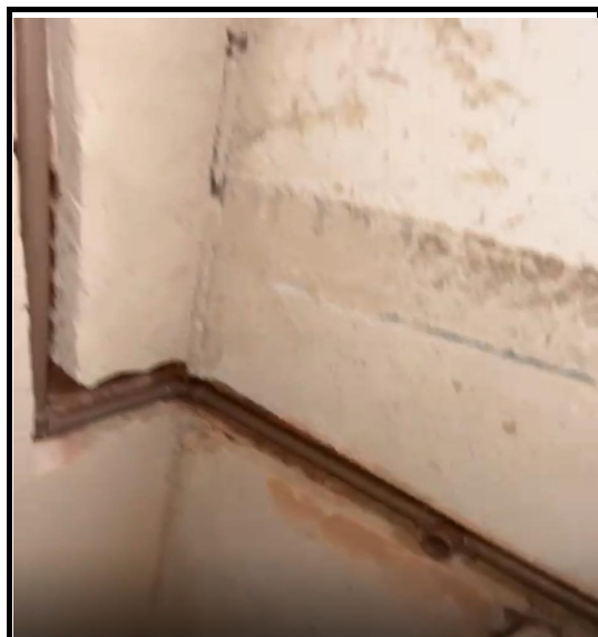
Figura 11 - tubo PVC - Cozinha
