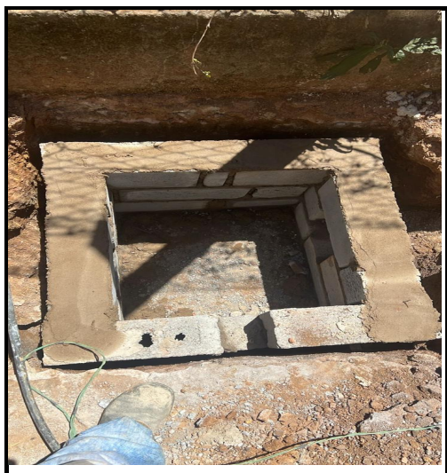
Figura 11 - Caixa de inspeção
