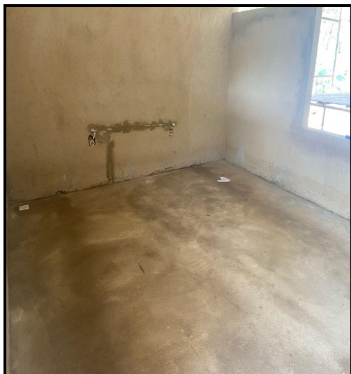
Figura 17 - Rede de água e esgoto e Ralo
