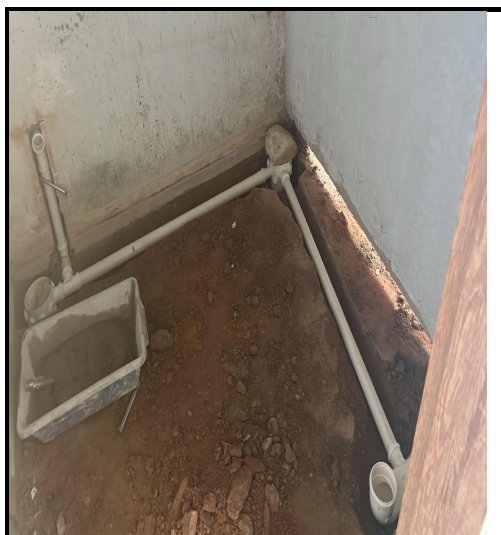
Figura 15 - tubo PVC de esgoto e Ralo
