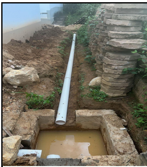
Figura 12 -tubo PVC de esgoto e Caixa de inspeção
