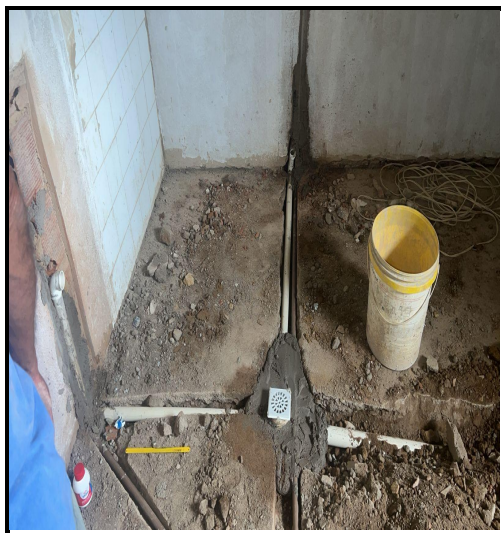
Figura 13 - Tubo PVC esgoto e Ralo
