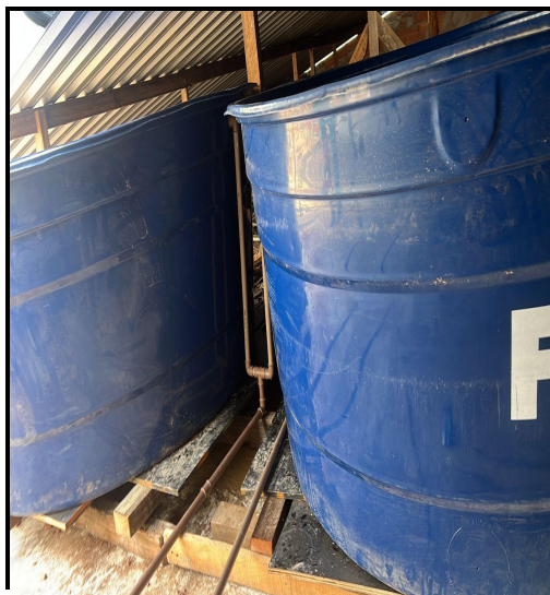
Figura 21 - Instalações hidráulicas (tubos e conexões) e caixa d'água
