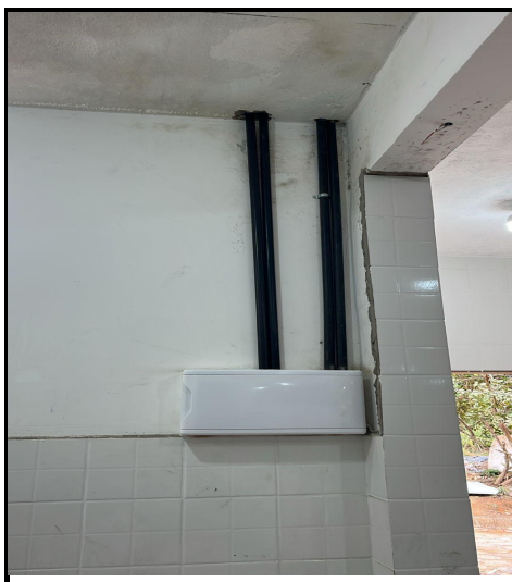
Figura 20 - Quadro elétrico; eletroduto rígido e cabos elétricos
