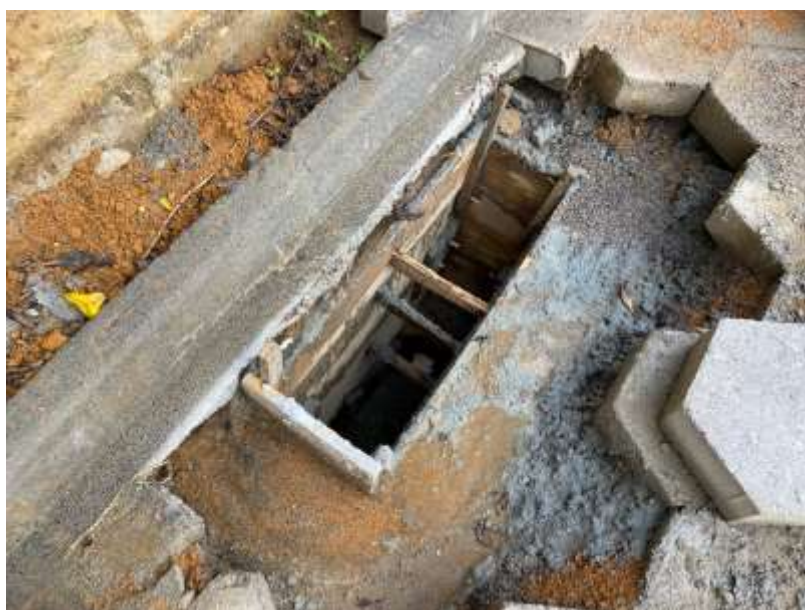
Boca de lobo simples em concreto. 31/10/2024.
