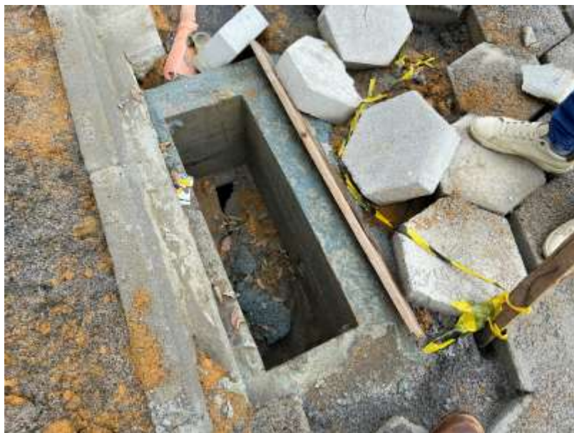
Boca de lobo simples em concreto. 31/10/2024.
