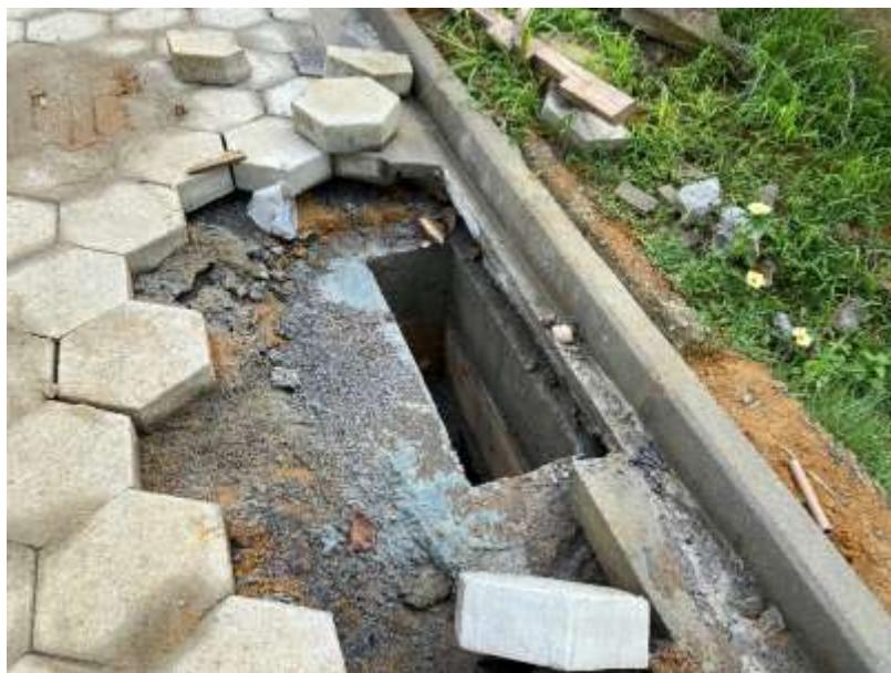
Boca de lobo simples em concreto. 31/10/2024.
