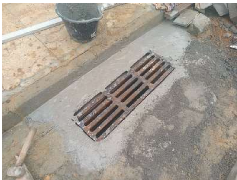
Boca de lobo simples em concreto. 04/11/2024.
