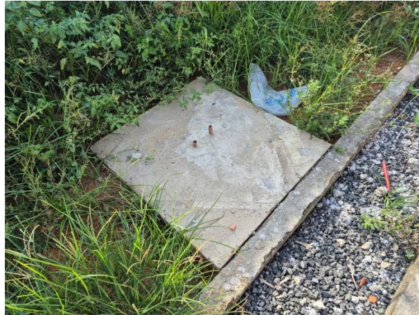
Foto 04 – Caixa de passagem em alvenaria para rede de esgoto – ano 2026 – Arquivo Pessoal
