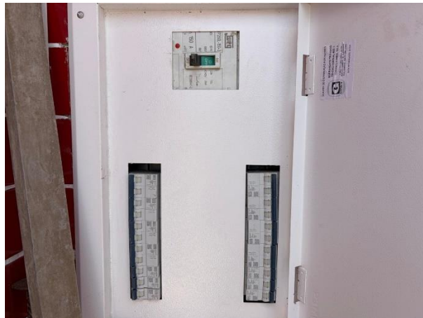
Foto 04 – Quadro de distribuição 2 – ano 2026 – Arquivo Pessoal
