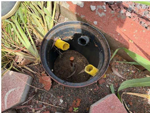
Foto 04 – Haste de aterramento em caixa ter – ano 2026 – Arquivo Pessoal
