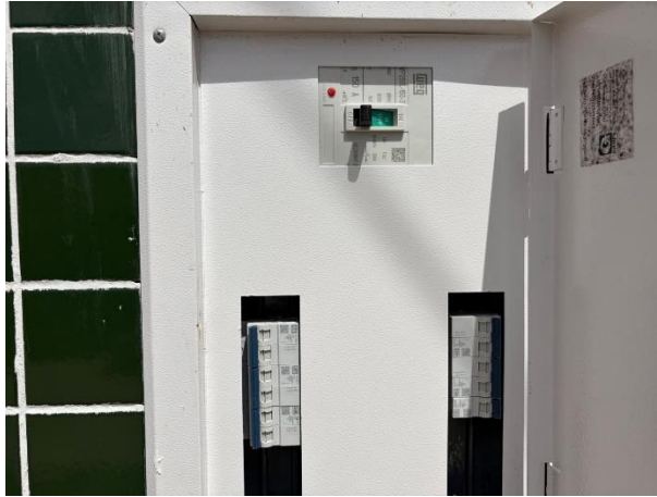
Foto 05 – Quadro de distribuição geral – ano 2026 – Arquivo Pessoal
