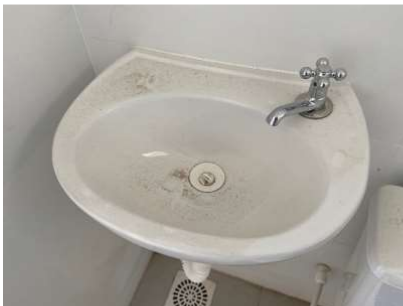
Lavatório em louça branca suspenso com torneira cromada de mesa. Em 22/07/2024.
