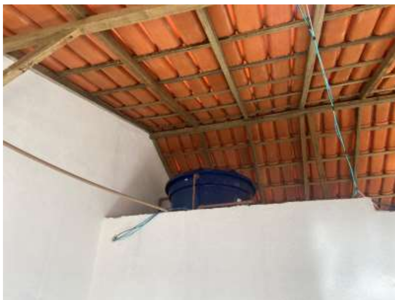
Reservatório de fibra de vidro, capacidade 310L. Em 22/07/2024.
