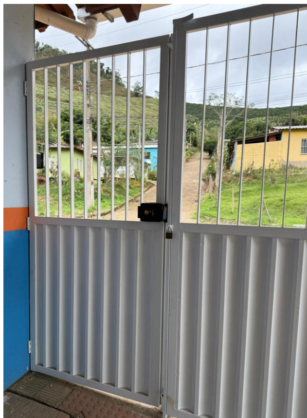
Fotos 04 e 05 – Item 03.10 – Portão de ferro em barra chata, chapa e tubo, inclusive chumbamento
