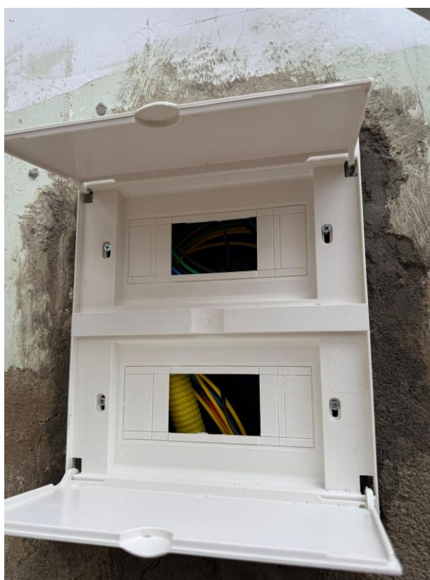
Fotos 31 e 32 – Item 13.09 - Quadro distrib. energia, embutido ou semi embutido, capac. p/ 16 disj. DIN, c/barram trif. 100A barra. Neutro e terra, fab. em chapa de aço 12 USG com porta, espelho, trinco com fechad ch yale, Ref. QDTN II-16DINCEMAR ou equiv.
