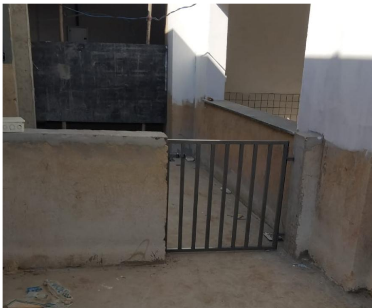
Figura 12 - - Item 06.09.01.02 - PORTÃO DE FERRO DE ABRIR EM BARRA CHATA, INCLUSIVE CHUMBAMENTO
