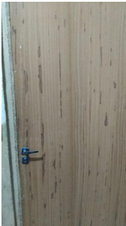
Foto 13 – Item 03.07.01 - PORTA EM MADEIRA DE LEI TIPO ANGELIM PEDRA OU EQUIV. 0,60X2,10M
