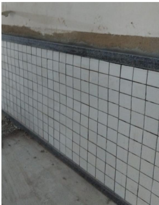
Fotos 10, 11 e 12 – Itens 03.06.01 e 03.06.04 - RODAPE DE MARMORE OU GRANITO; RODA PAREDE EM GRANITO CINZA ANDORINHA
