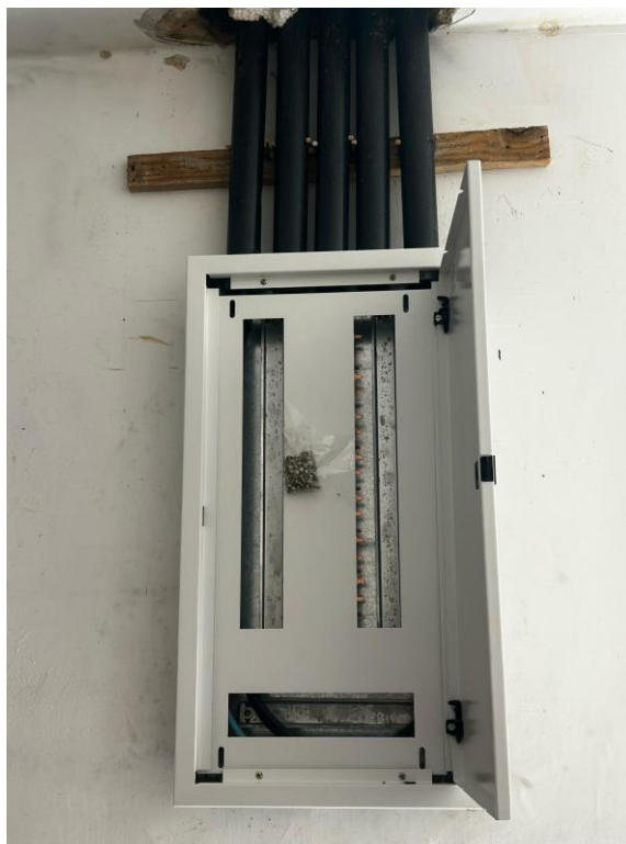
Foto 30 – Item 09.04.02 - - Quadro distrib. energia embutido ou semi embutido, capac. p/28 disj.
