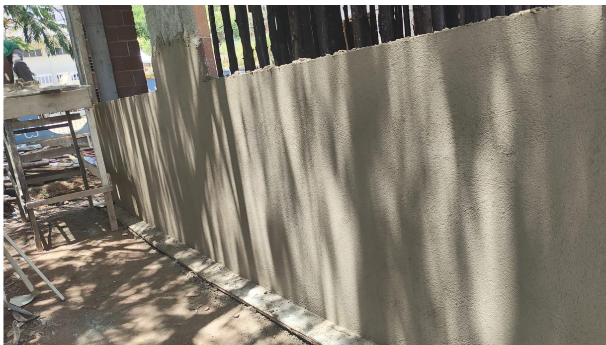
Fotos 07 e 08 – Item 03.02.02 – Reboco de argamassa de cimento, cal hidratada e areia média ou grossa lavada
