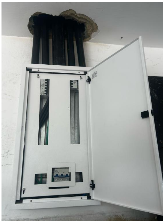
Foto 29 – Item 09.04.04 – Quadro distrib. energia embutido ou semi embutido, capac. p/44 disj.
