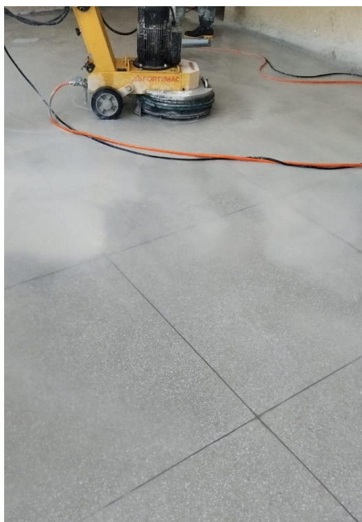
Fotos 09 , 10, 11 e 12 – Item 03.05.03 – Piso argamassa alta resistência tipo granilite, com acabamento polido mecanizado
