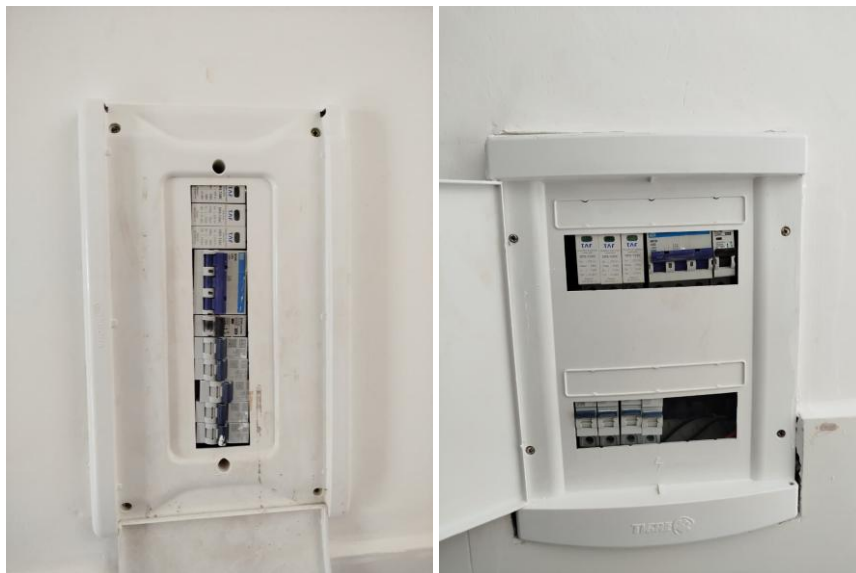
Figuras 12 e 13 – Itens 13.10, 13.11, 13.12, 13.16 e 13.19 – Mini-Disjuntor monopolar 10 A, curva C - 5KA 220/127VCA (NBR IEC 60947-2), Ref. Siemens, GE, Schneider ou equivalente; Mini-Disjuntor monopolar 16 A, curva C - 5KA 220/127VCA (NBR IEC 60947-2), Ref. Siemens, GE, Schneider ou equivalente; Mini-Disjuntor monopolar 40 A, curva C - 5KA 220/127VCA (NBR IEC 60947-2), Ref. Siemens, GE, Schneider ou equivalente; Dispositivo de proteção contra surto (DPS) bipolar, tensão nominal máxima 275VCA, corrente de surto máxima 40KA; Quadro de distribuição de energia, de embutir, com 24 divisões modulares, com barramento.
