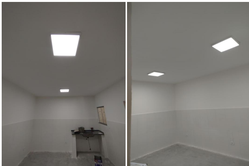
Figuras 24 e 25 – Itens 16.07 e 17.05 - Luminária sobrepor quadrada Led 40W*, 6500K G- Light ou similar; Pintura em paredes e forros, aplicação manual, com três demãos de tinta látex premium, referência Suvinil, Coral e Metalatex, inclusive uma demão de líquido selador PVA, referência Suvinil, Coral ou Metalatex ou equivalente.
