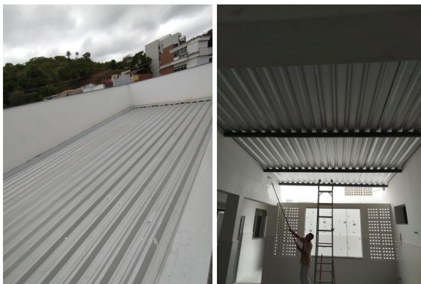
Figuras 5 e 6 – item 07.11 - TELHAMENTO COM TELHA METÁLICA TERMOACÚSTICA E = 30 MM, COM ATÉ 2 ÁGUAS M2, INCLUSO IÇAMENTO. AF_07/2019;
