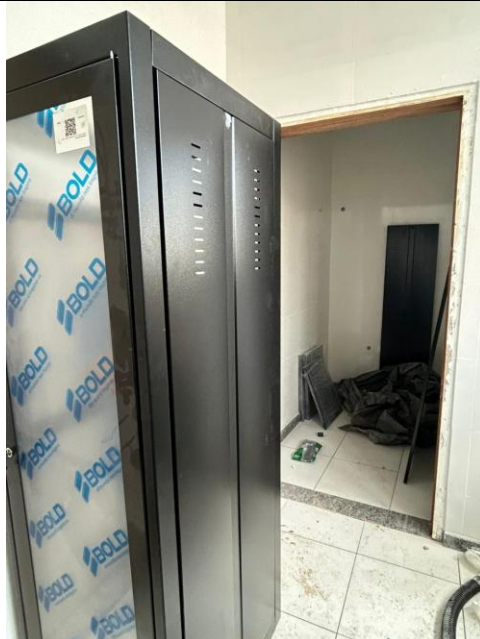
Foto 16 – Itens 10.05.01, 10.05.02, 10.05.03, 10.05.05 e 10.05.06 - FORNECIMENTO E INSTALAÇÃO DE MINI RACK DE PAREDE PADRÃO 19" - 12 U'S X 570MM; BANDEJA FIXAÇÃO DUPLA 1 U X 500MM CARGA MÁXIMA 20KG, INCLUSIVE FIXAÇÃO EM RACK 19"; PATCH PANEL 24 PORTAS RJ45/IDC CAT.5E, INCLUSIVE FIXAÇÃO EM RACK 19"; CALHA COM 8 TOMADAS 20A, INCLUSIVE FIXAÇÃO EM RACK PADRÃO 19", COM CHICOTE DE 2 METROS DE COMPRIMENTO; PATCH CORD MULTILAN EXTRA FLEXÍVEL CAT 5E U/UTP RJ-45 – 1,50 M.
