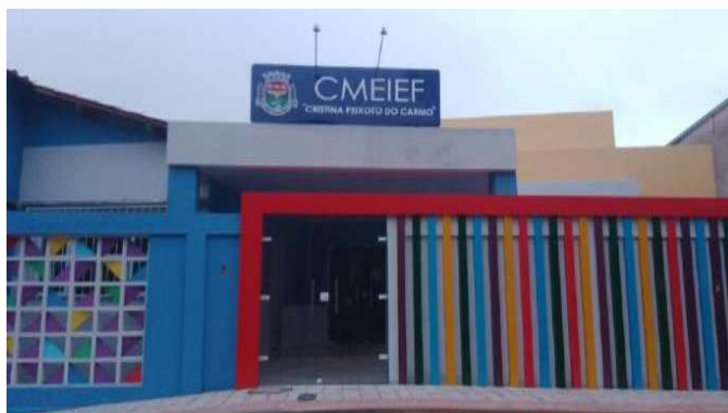
Foto de como está ficando a entrada e fachada da escola, após a pintura
