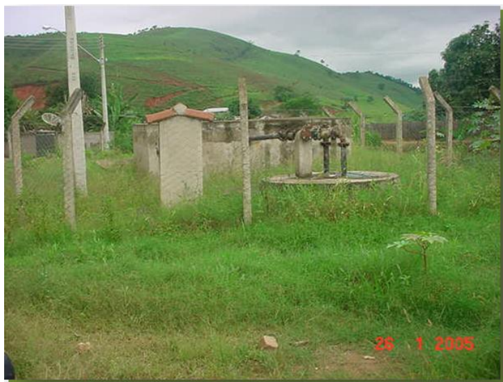
Figura 22: Vista da fossa filtro.
