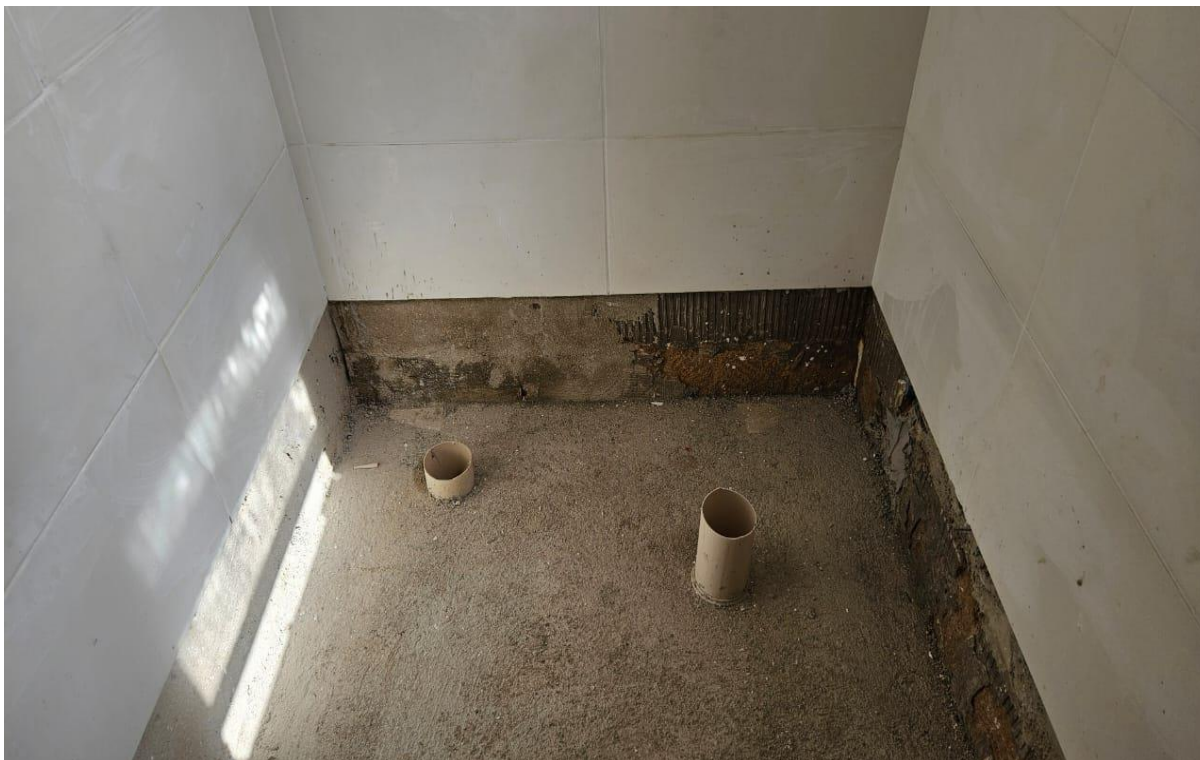
Foto 21: Pontos de esgoto
