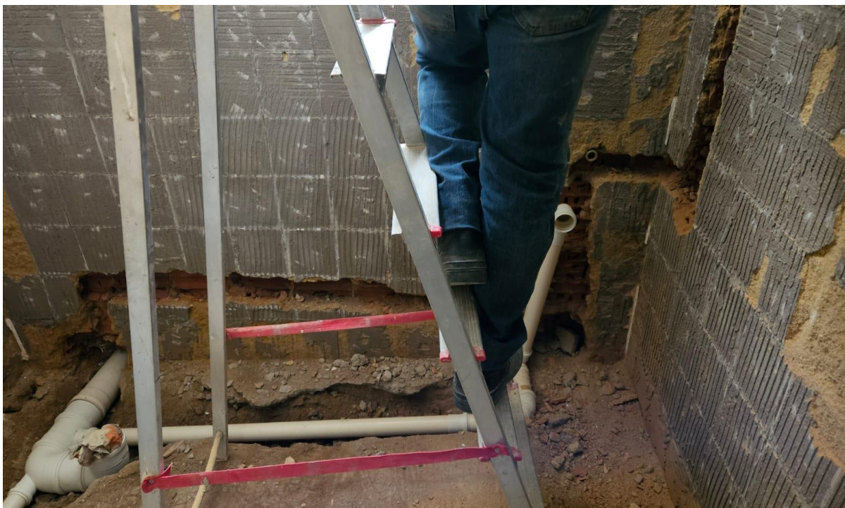
Foto 22: Pontos de esgoto
