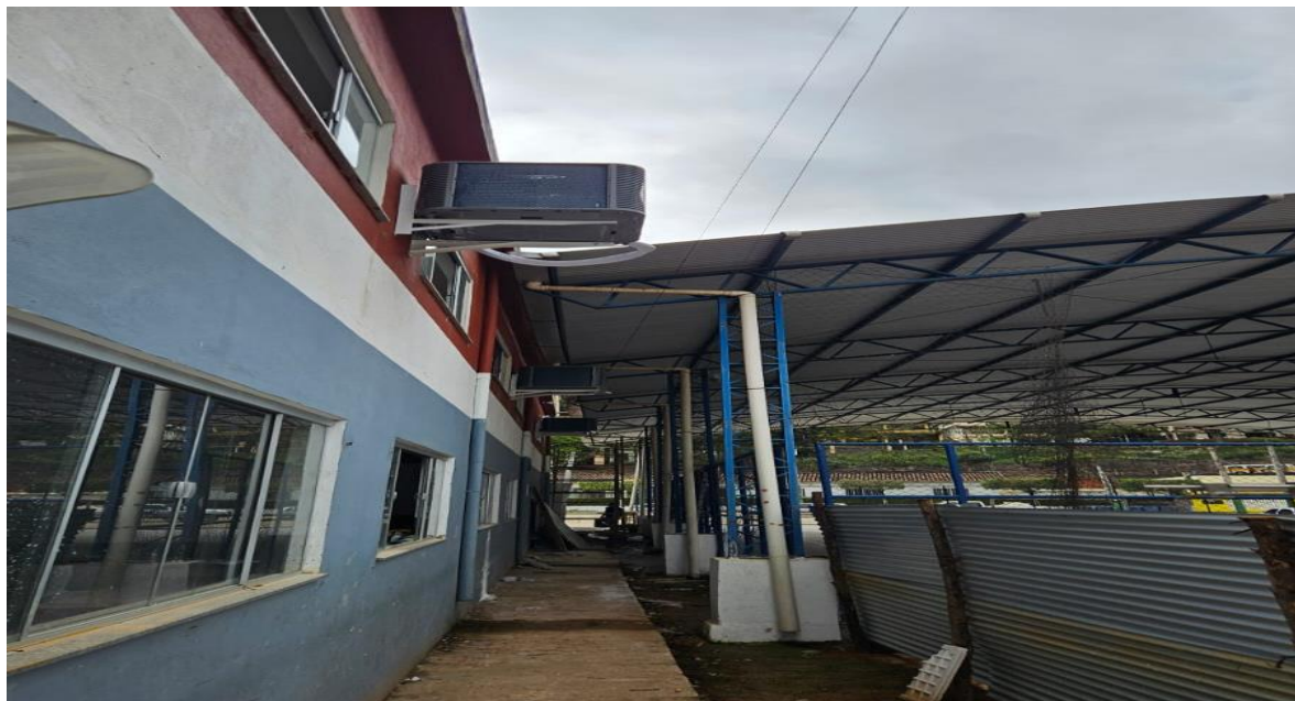
Foto 31: Motores Ar condicionado
