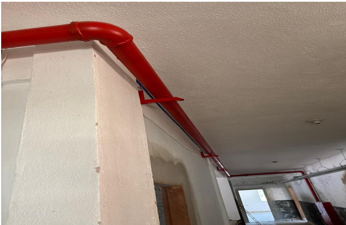
Foto 51: tubulação combate Incêndio
