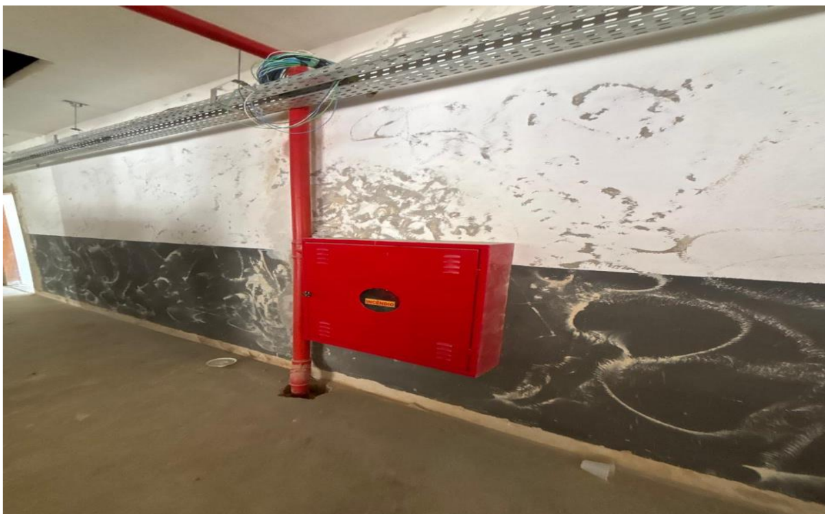
Foto 53: tubulação combate Incêndio
