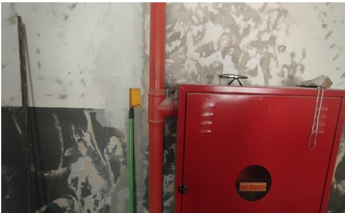
Foto 58: tubulação combate Incêndio
