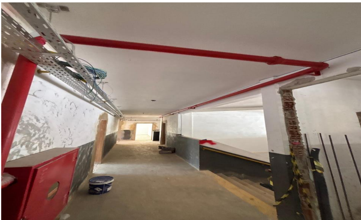
Foto 52: tubulação combate Incêndio
