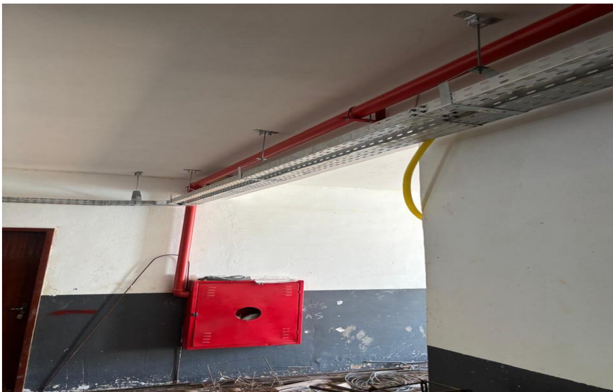
Foto 54: tubulação combate Incêndio
