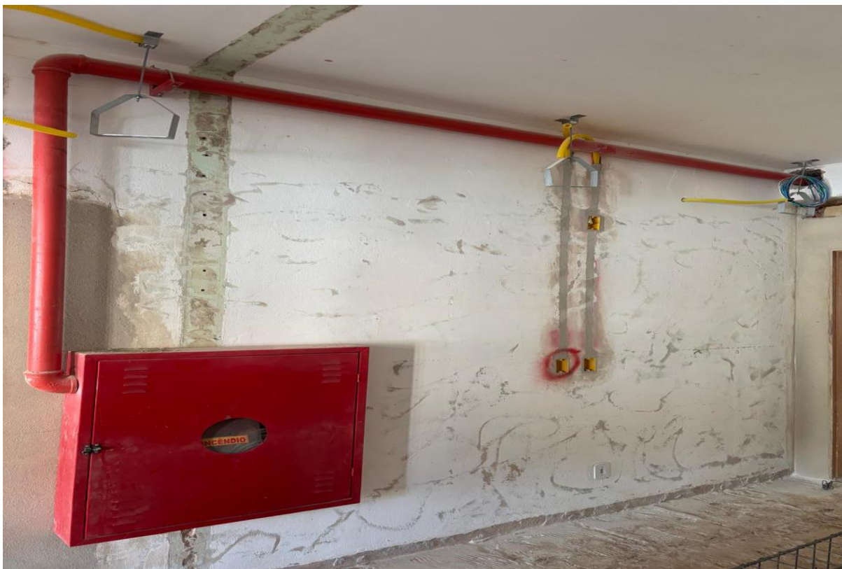
Foto 55: tubulação combate Incêndio
