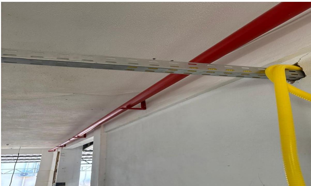
Foto 57: tubulação combate Incêndio
