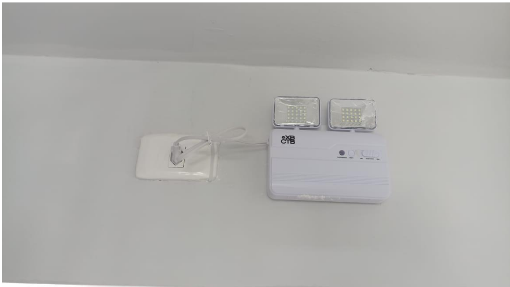
Figura 30 - Detalhe para ponto para iluminação de emergência e luminária
