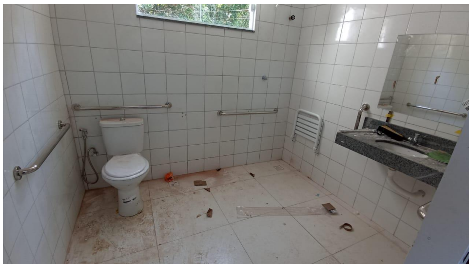
Figura 4 – Detalhe para barras de apoio, bacia, torneira de pressão, cuba e espelho banheiro PCD
