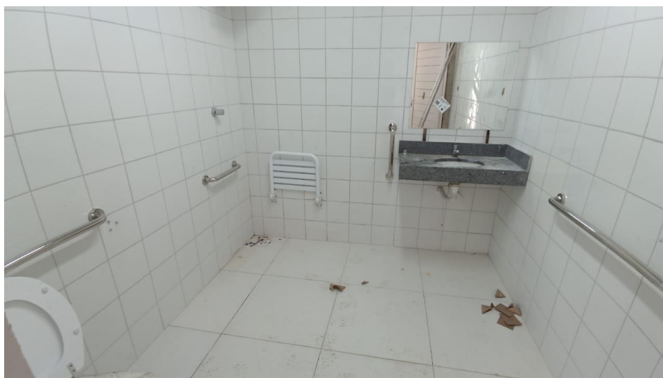
Figura 6 - Detalhe para barras de apoio, torneira de pressão, cuba e espelho banheiro PCD
