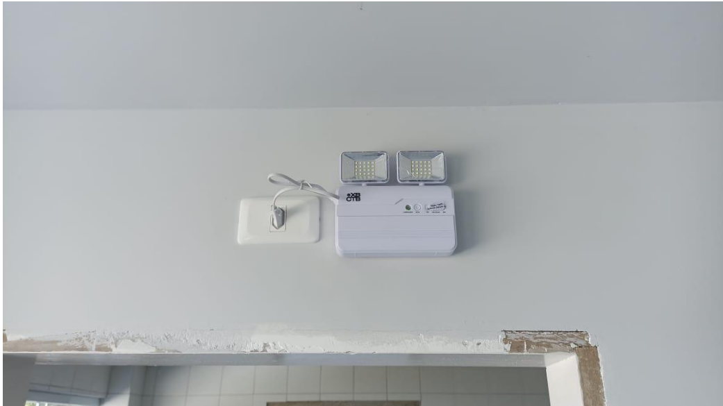
Figura 29 - Detalhe para ponto para iluminação de emergência e luminária
