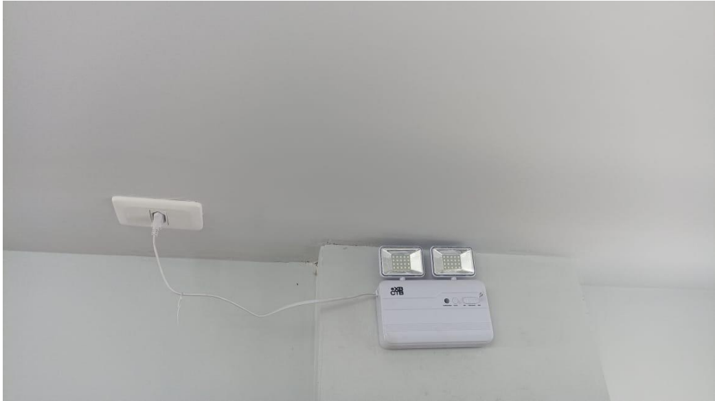
Figura 31 - Detalhe para ponto para iluminação de emergência e luminária
