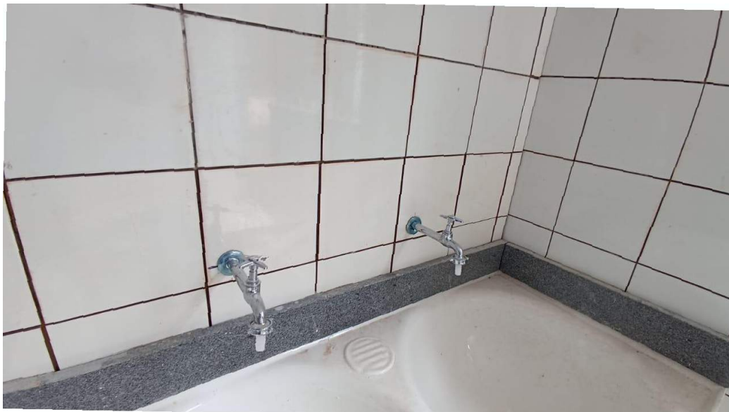
Figura 45 - Detalhe para torneiras área de serviço
