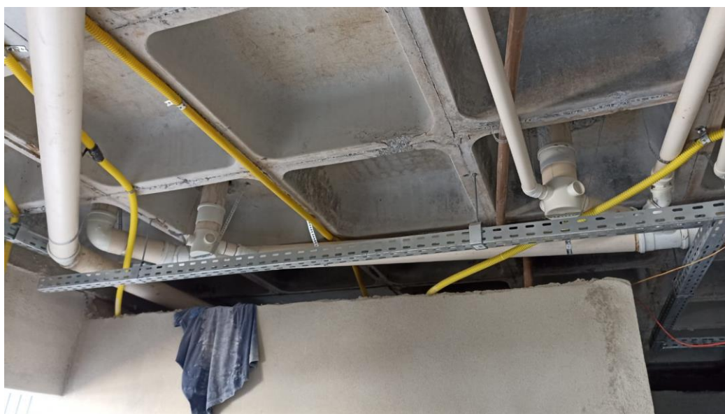
Figura 24 - Detalhe para infraestrutura de cabeamento de rede e instalações hidrossanitárias
