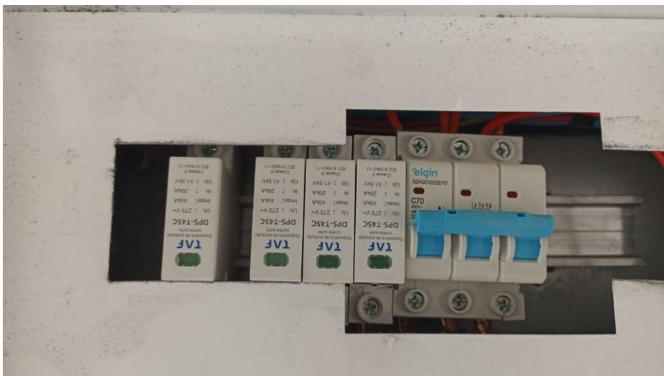
Figura 6 - Detalhe para disjuntores elétricos – pavimento superior
