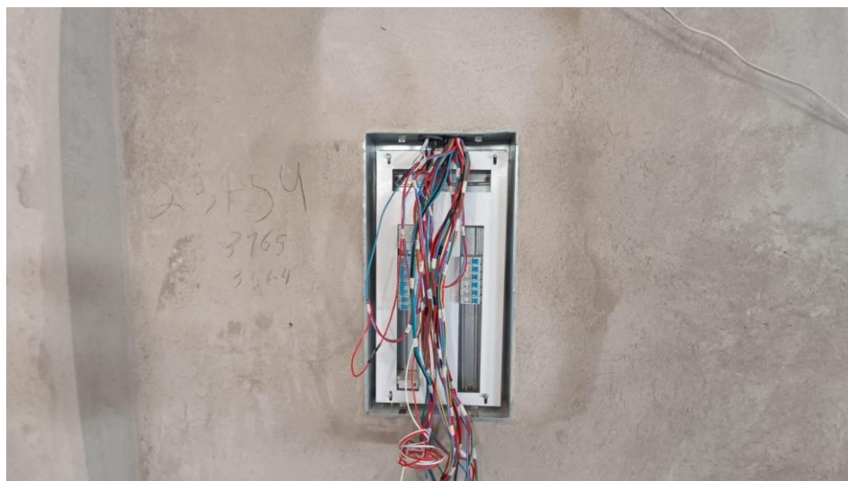
Figura 4 – Detalhe para disjuntores elétricos – terréo
