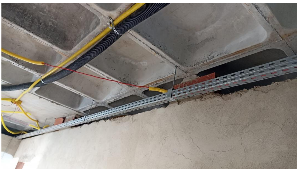
Figura 20 - Detalhe para infraestrutura de cabeamento de rede
