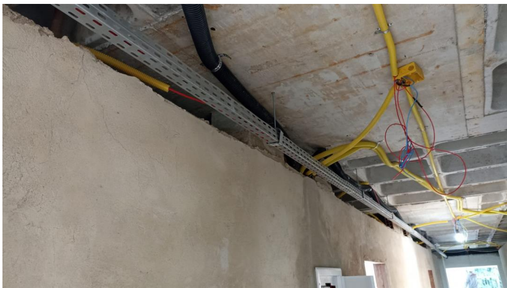
Figura 21 - Detalhe para infraestrutura de cabeamento de rede
