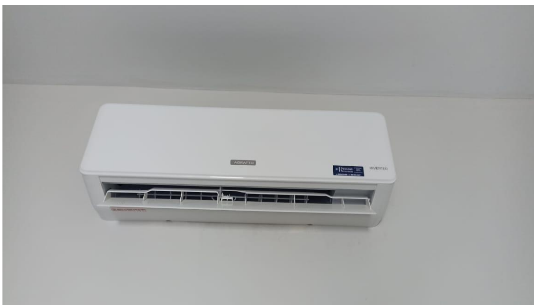
Figura 25 – Detalhe para ar condicionado instalado
