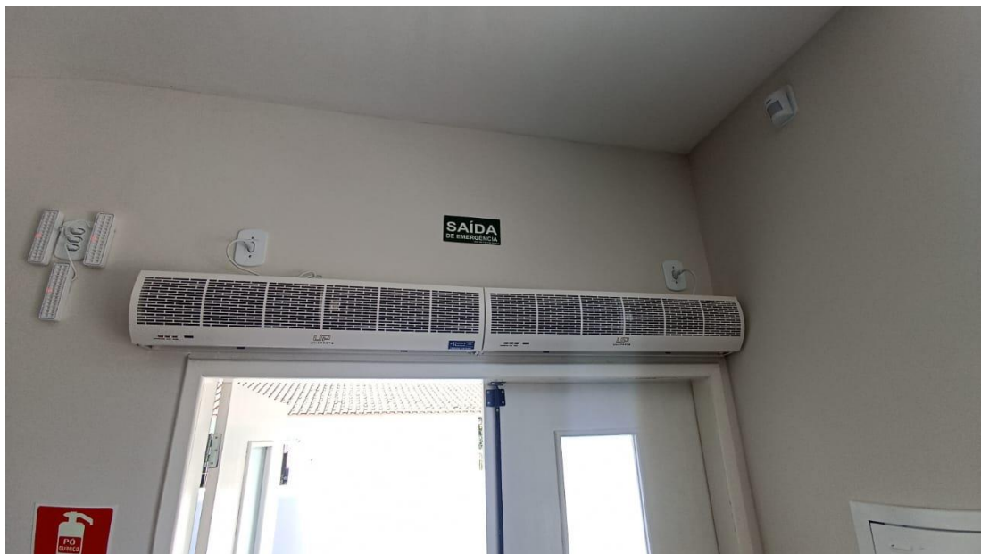
Figura 27 – Detalhe para cortina de ar instalada sobre porta
