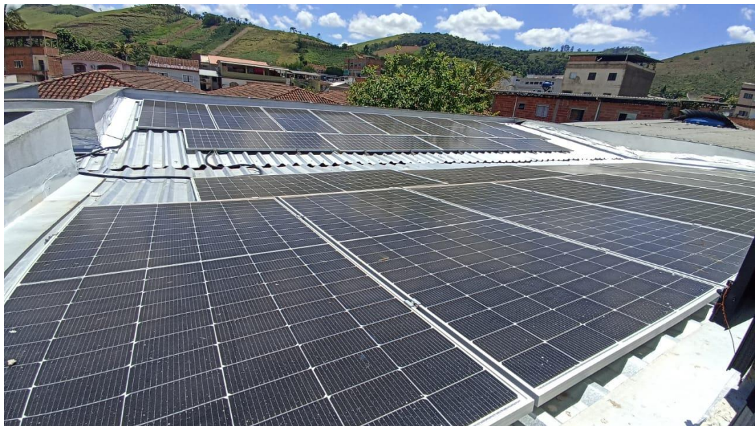
Figura 52 – Detalhe para sistema de energia solar (placas)
