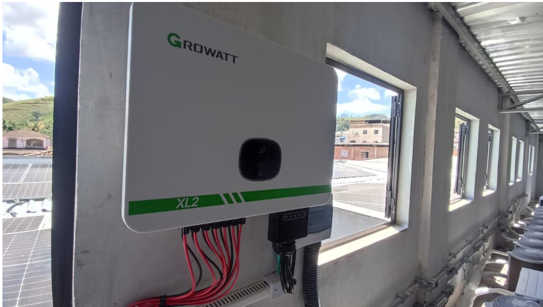
Figura 53 – Detalhe para sistema de energia solar (inversor solar)
