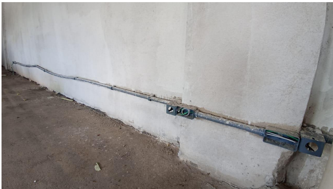
Figura 54 – Detalhe para eletroduto PVC rígido
