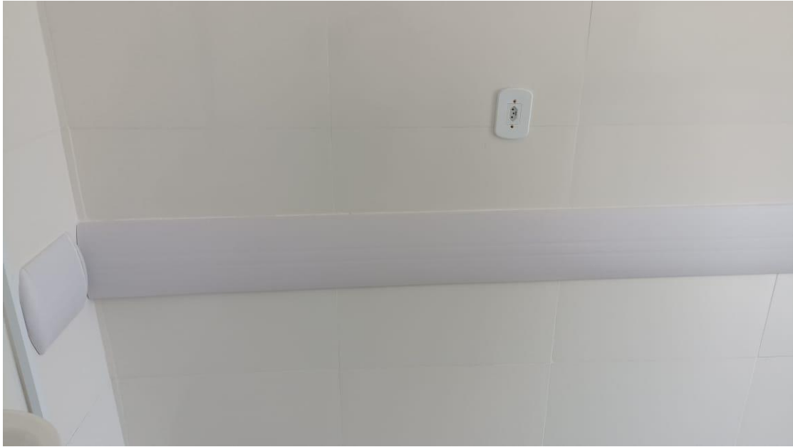
Figura 11 – Detalhe para bate-maca em PVC
