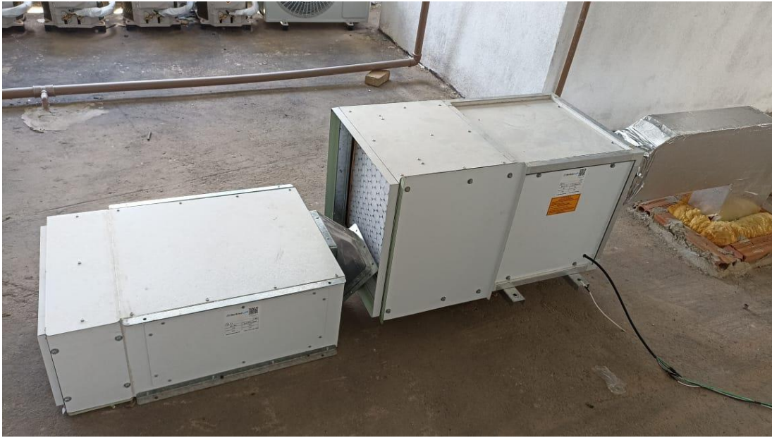
Figura 30 – Detalhe para gabinetes de ventilação com filtro instalados
