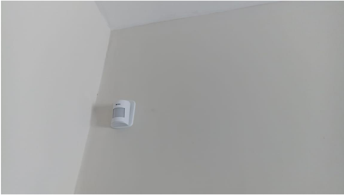
Figura 47 – Detalhe para sensor de presença passivo
