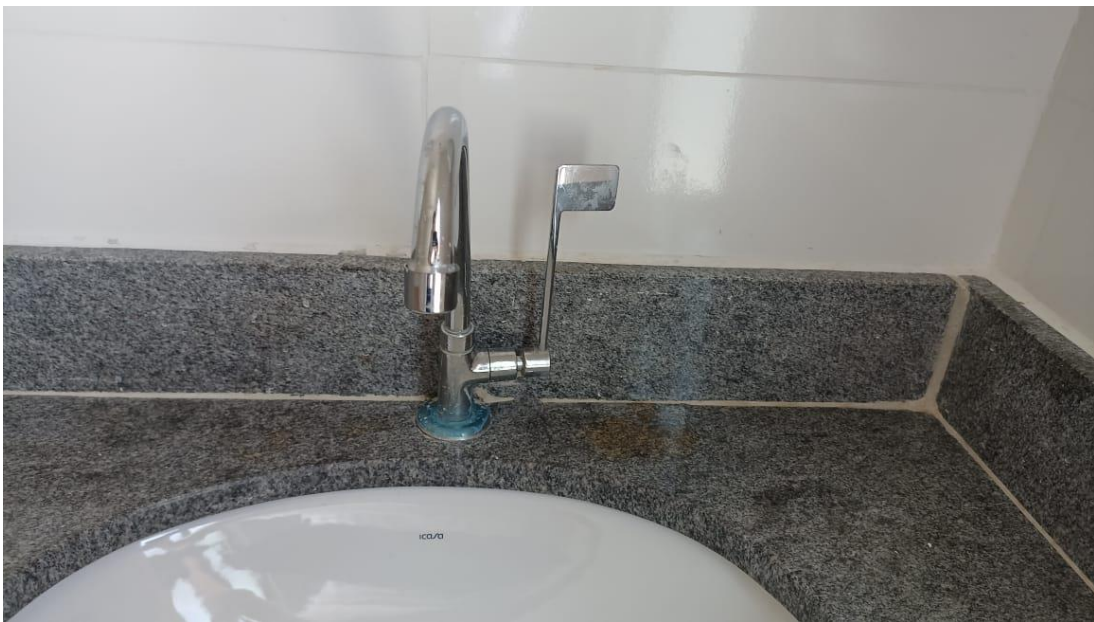
Figura 58 – Detalhe para torneira tipo alavanca do lavatório
