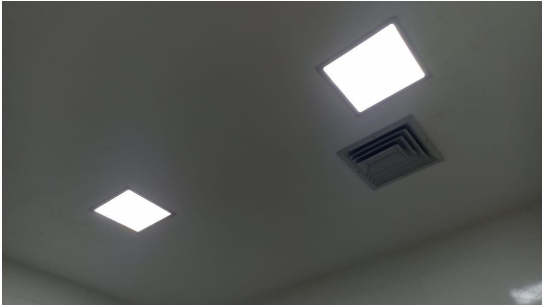
Figura 41 – Detalhe luminárias de embutir de led instaladas
