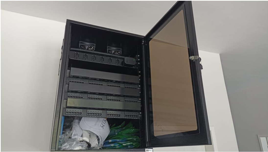
Figura 33 – Detalhe para hack de cabeamento estruturado instalado
