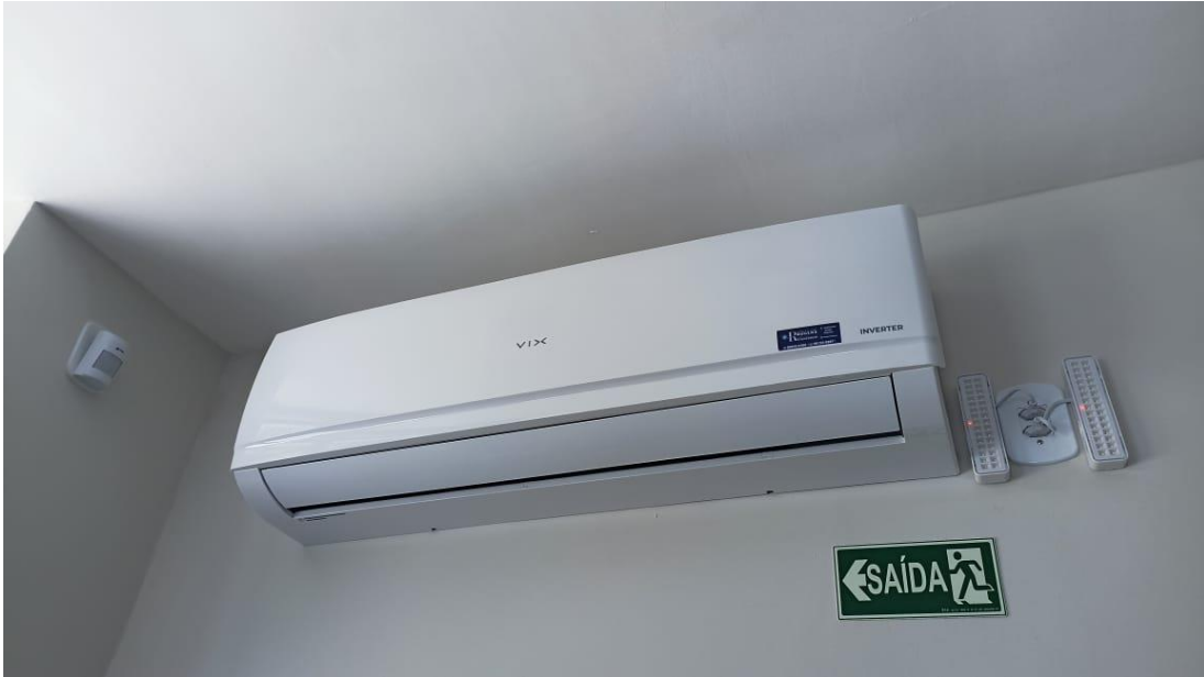
Figura 20 – Detalhe para ar condicionado instalado
