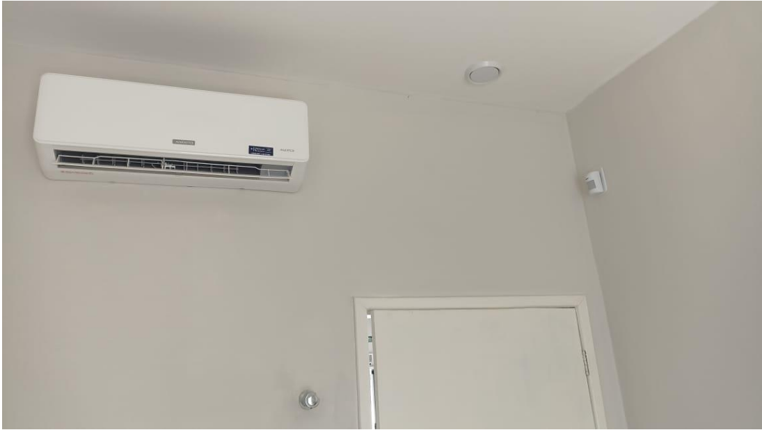
Figura 18 – Detalhe para ar condicionado instalado
