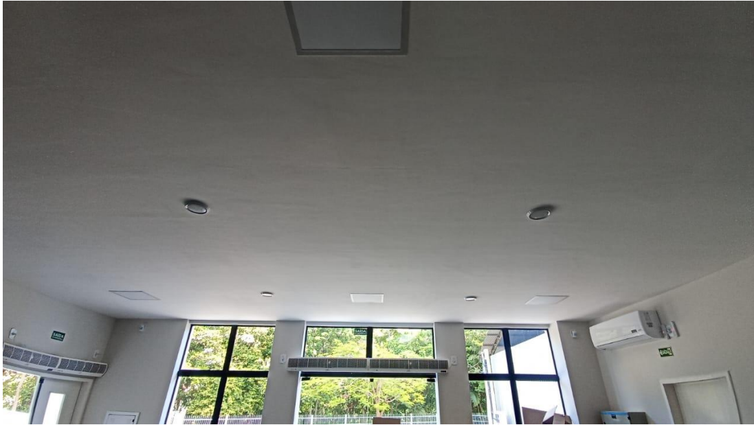
Figura 45 – Detalhe luminária de embutir de led instaladas
