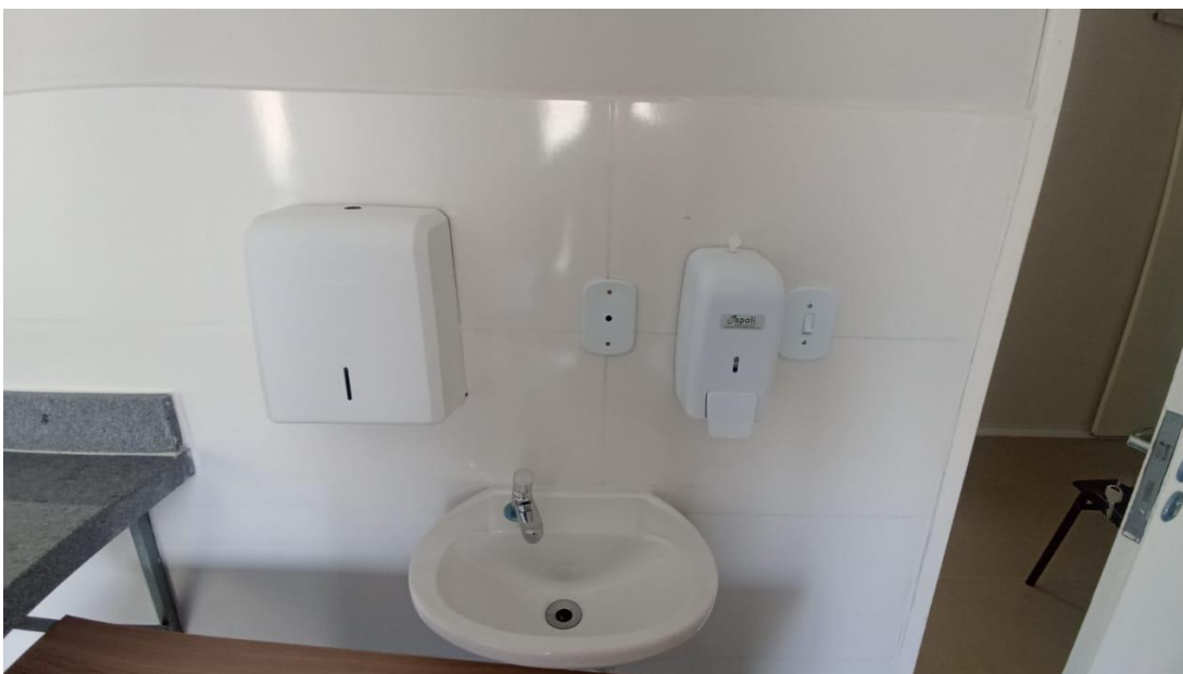
Figura 60 – Detalhe para saboneteira e dispenser para papel toalha
