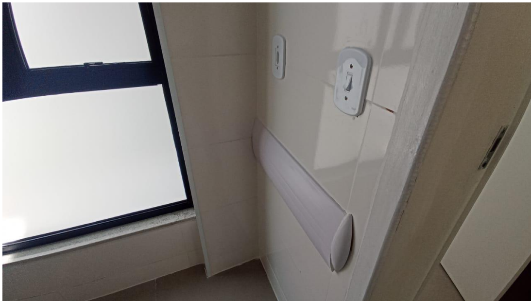
Figura 14 – Detalhe para bate-maca em PVC
