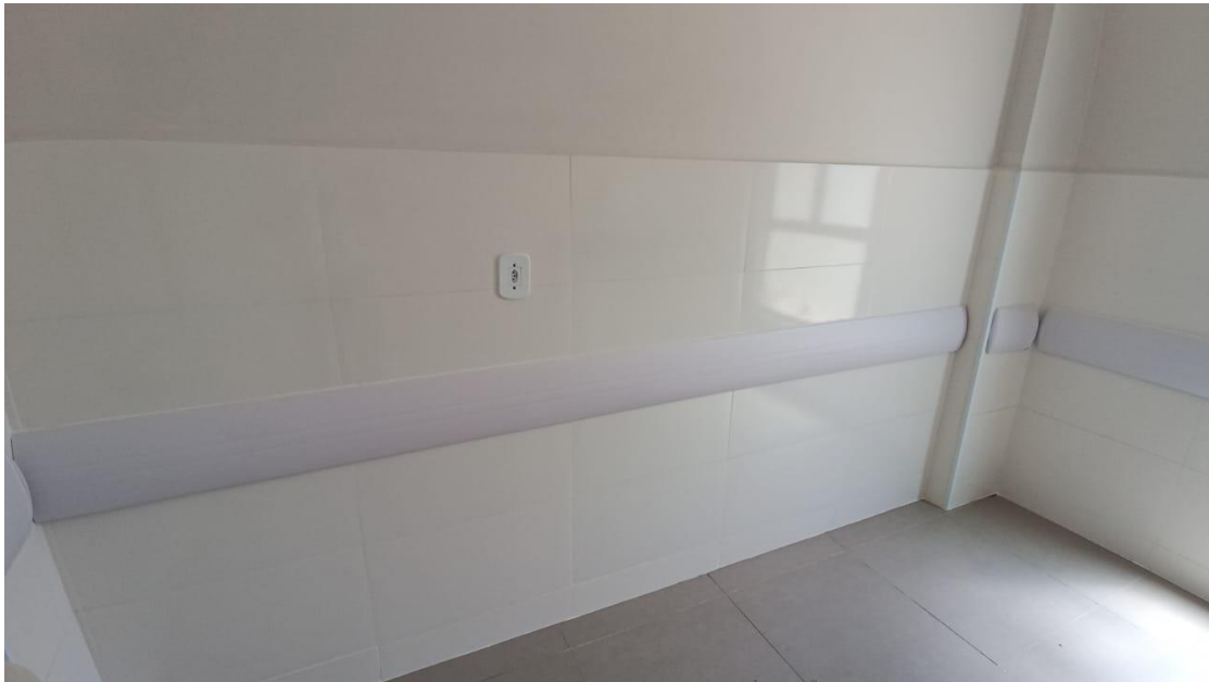
Figura 12 – Detalhe para bate-maca em PVC
