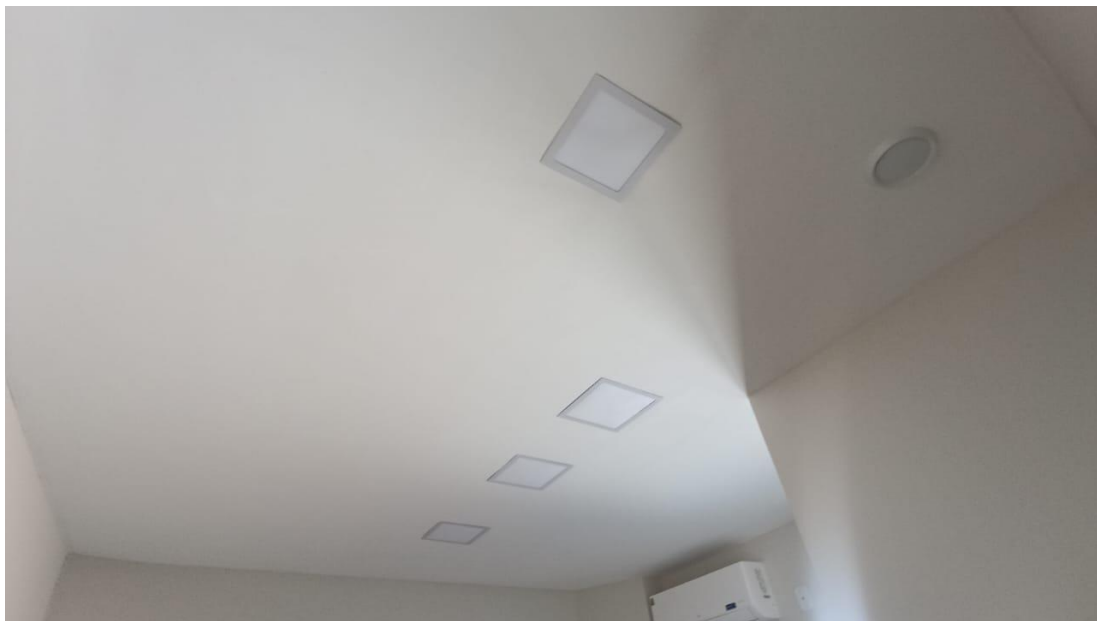
Figura 44 – Detalhe luminárias de embutir de led instaladas
