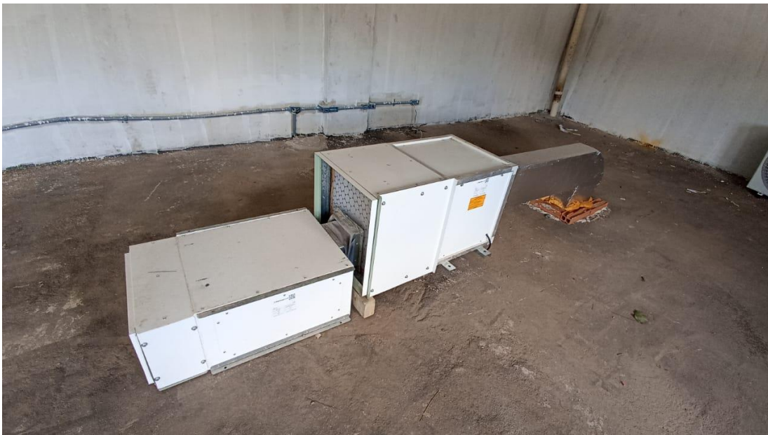
Figura 31 – Detalhe para gabinetes de ventilação com filtro instalados
