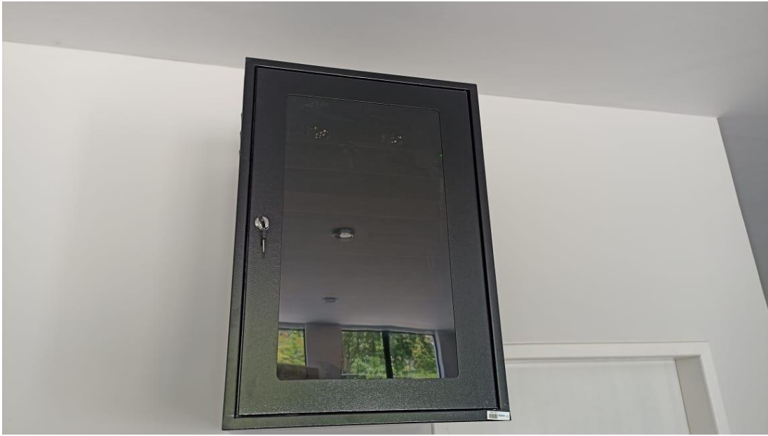
Figura 32 – Detalhe para hack de cabeamento estruturado instalado
