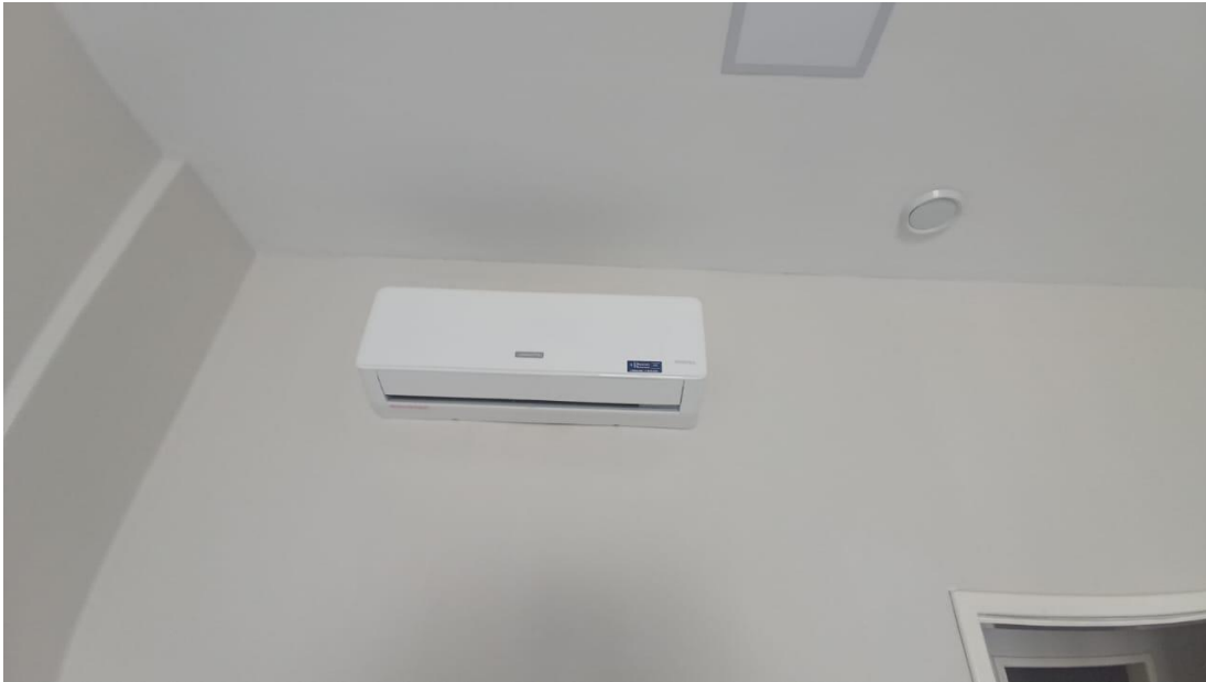
Figura 22 – Detalhe para ar condicionado instalado
