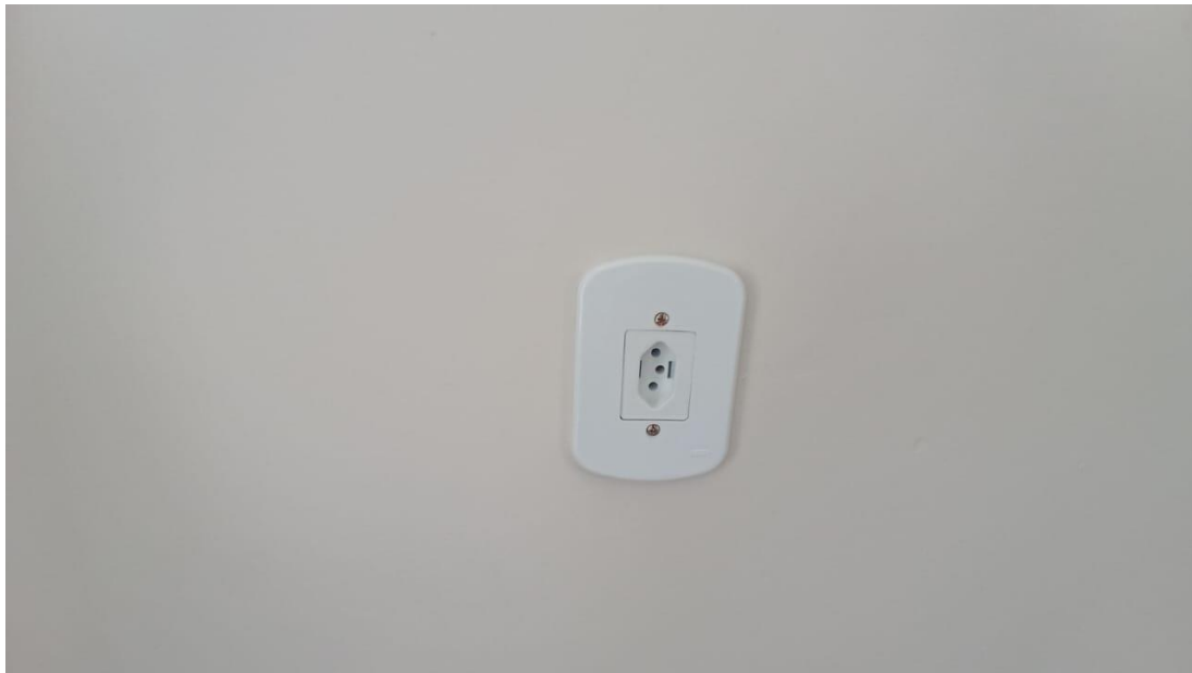
Figura 35 – Detalhe para tomada 2p+t instalada
