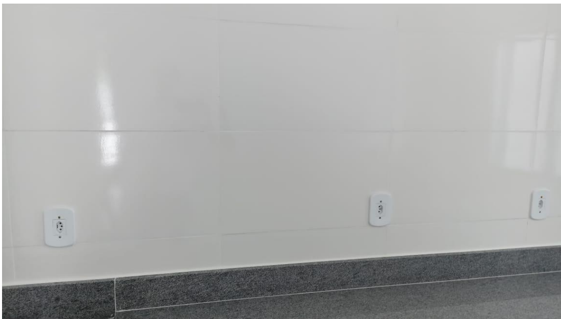
Figura 36 – Detalhe para tomadas 2p+t instaladas
