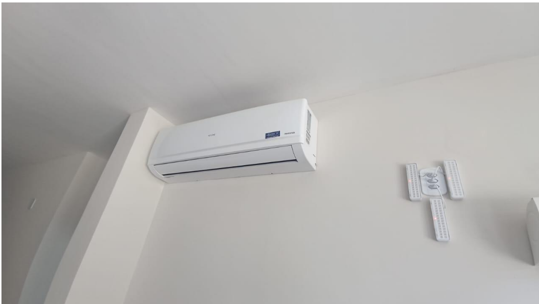
Figura 19 – Detalhe para ar condicionado instalado
