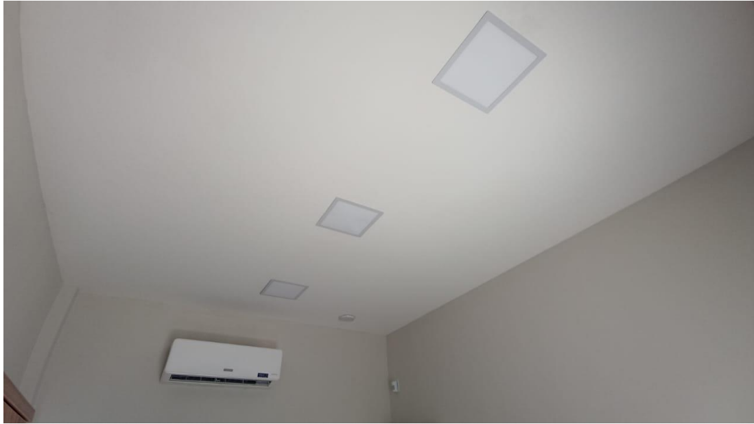
Figura 26 – Detalhe para ar condicionados instalados
