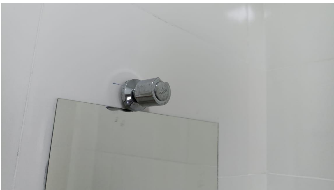
Figura 62 – Detalhe para registro geral dos banheiros
