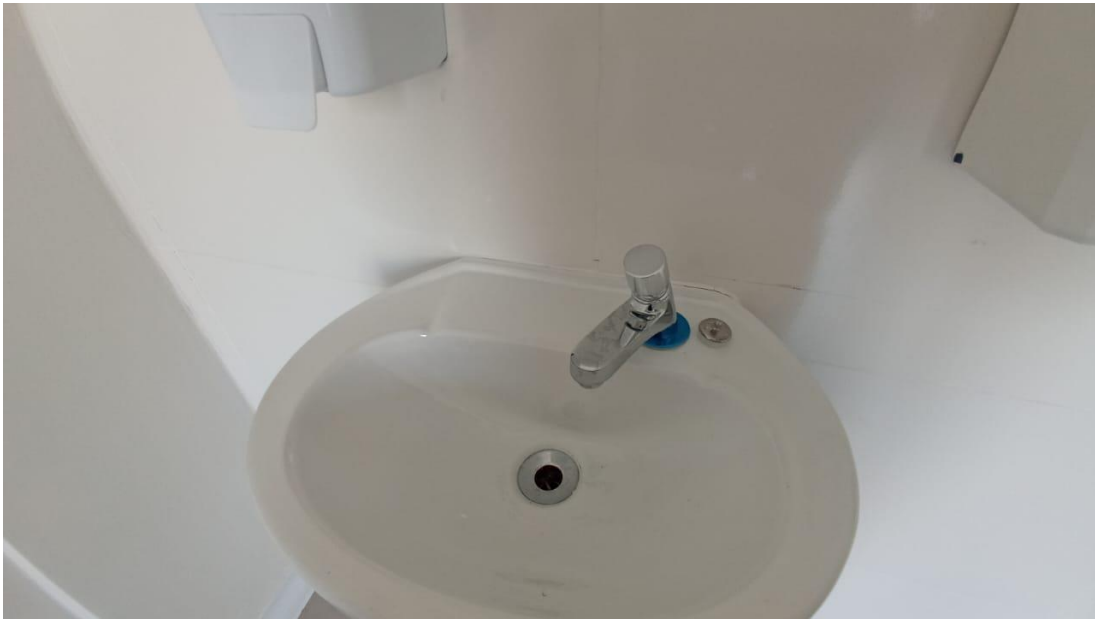
Figura 56 – Detalhe para torneira de pressão do lavatório
