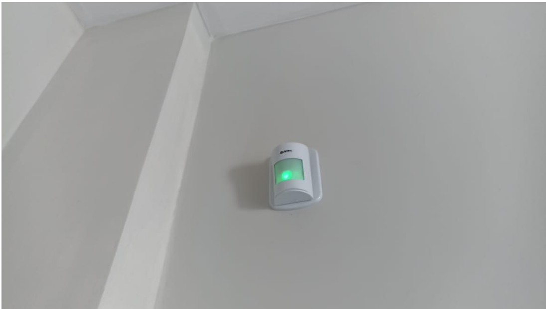
Figura 48 – Detalhe para sensor de presença passivo
