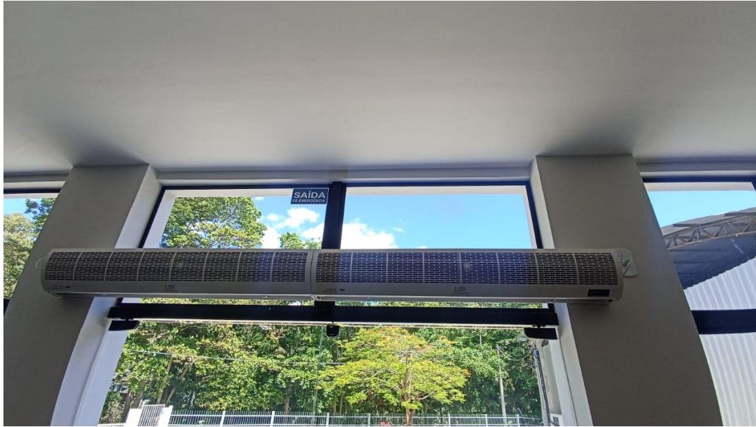
Figura 28 – Detalhe para cortina de ar instalada sobre a porta
