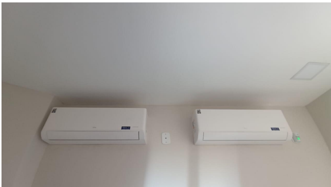
Figura 24 – Detalhe para ar condicionados instalados
