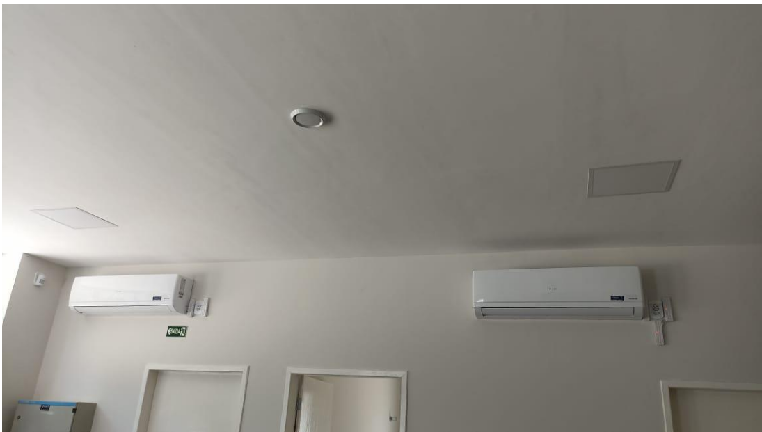
Figura 21 – Detalhe para ar condicionados instalados
