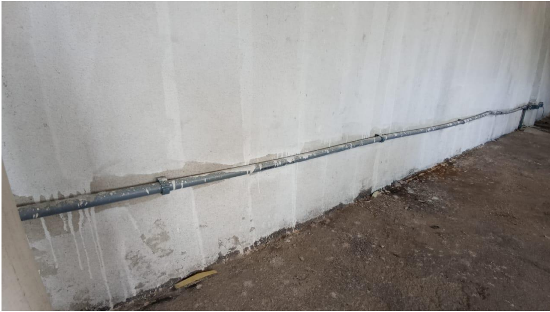
Figura 55 – Detalhe para eletroduto PVC rígido
