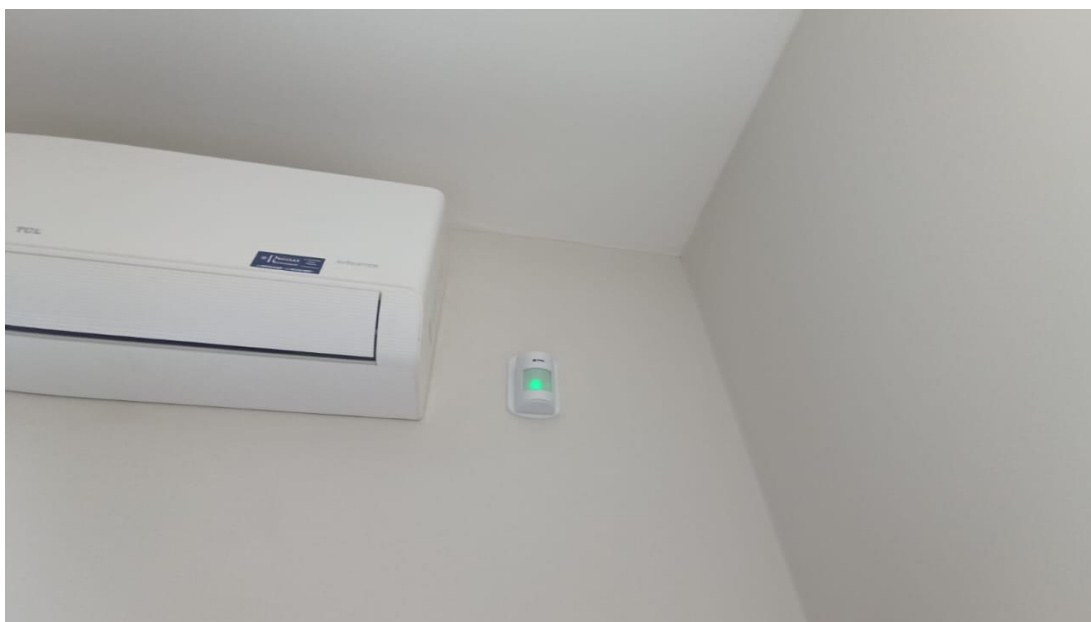
Figura 49 – Detalhe para sensor de presença passivo
