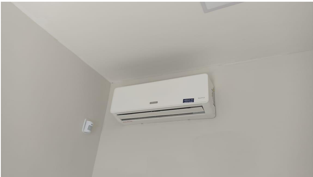
Figura 23 – Detalhe para ar condicionados instalados
