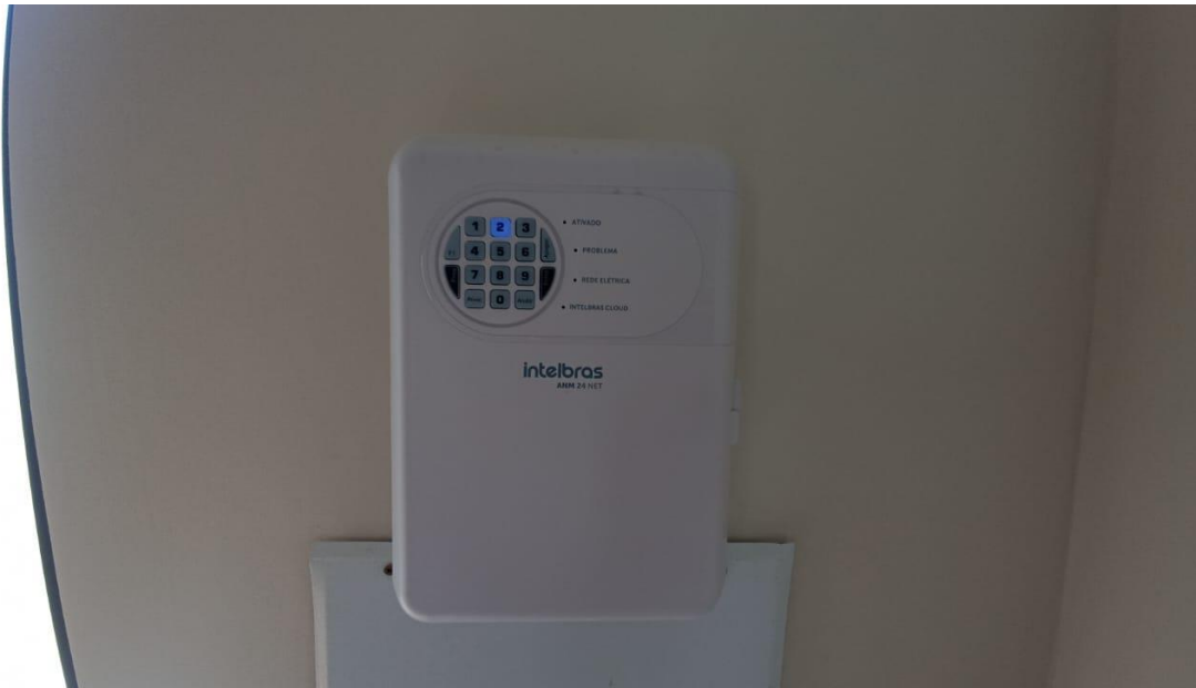
Figura 51 – Detalhe para central de alarme monitorada
