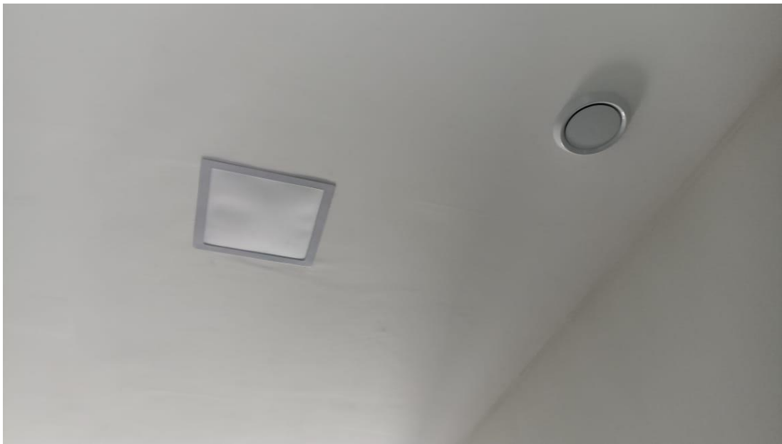
Figura 43 – Detalhe luminária de embutir de led instalada
