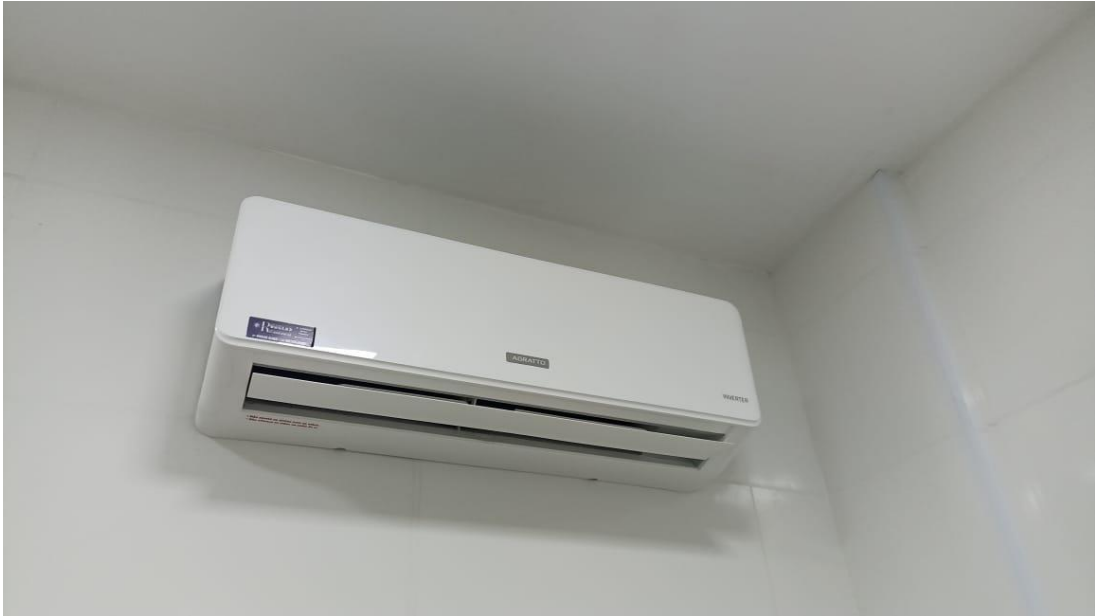
Figura 16 – Detalhe para ar condicionado instalado
