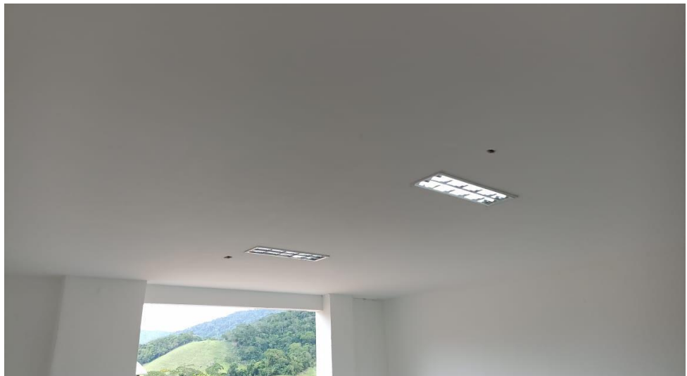
Figura 14 - Detalhe para luminárias de sobrepor
