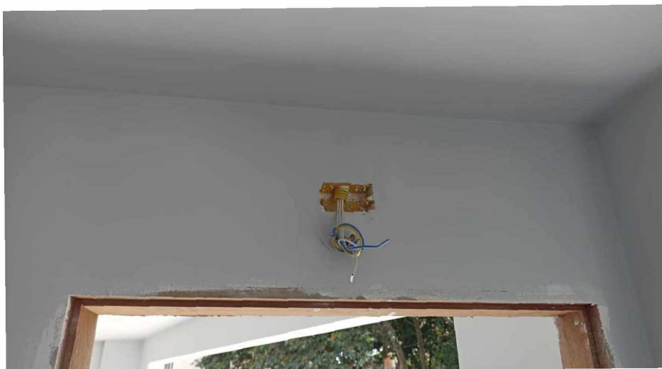
Figura 1 – Detalhe para ponto elétrico para luminárias de emergência – pavimento superior
