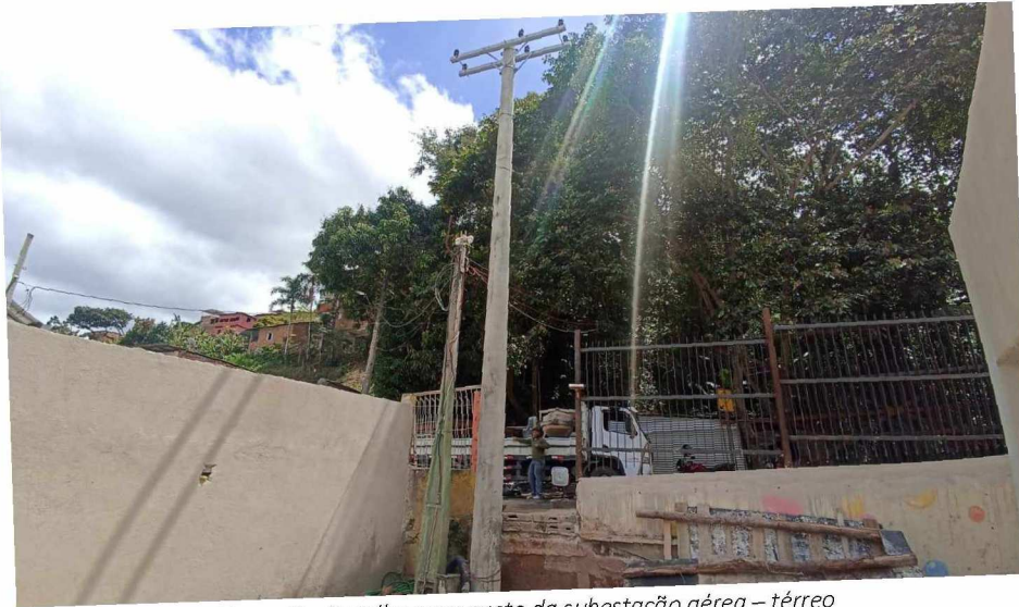
Figura 8 - Detalhe para poste da subestação aérea – térreo
