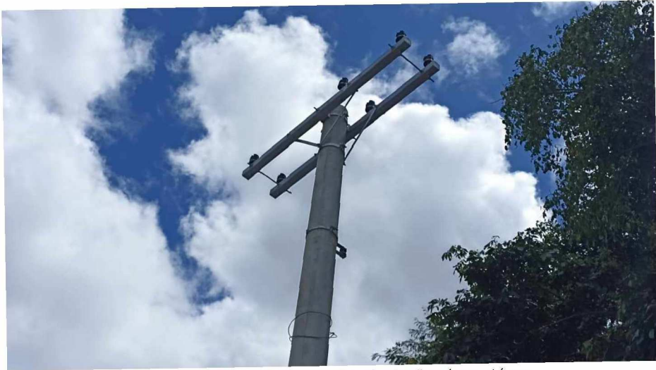
Figura 9 - Detalhe para poste da subestação aérea – térreo
