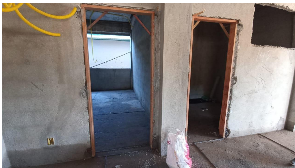
Figura 2 - Detalhe para assentamentos dos batentes das portas
