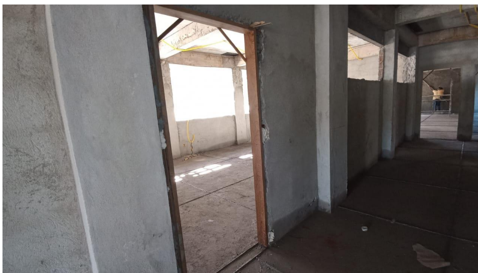
Figura 3 - Detalhe para assentamentos dos batentes das portas
