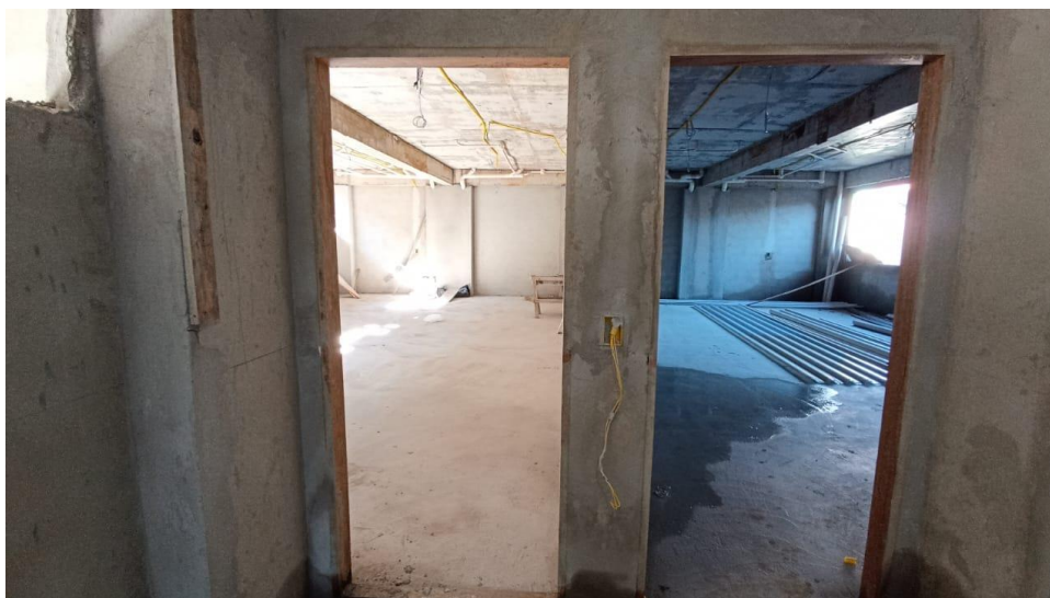
Figura 5- Detalhe para assentamentos dos batentes das portas
