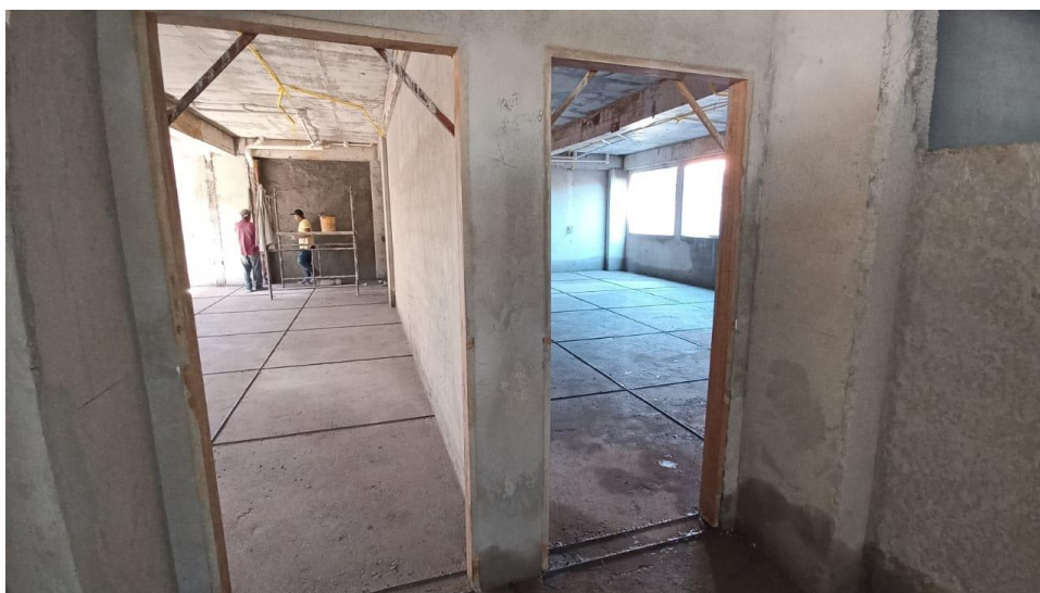
Figura 4- Detalhe para assentamentos dos batentes das portas
