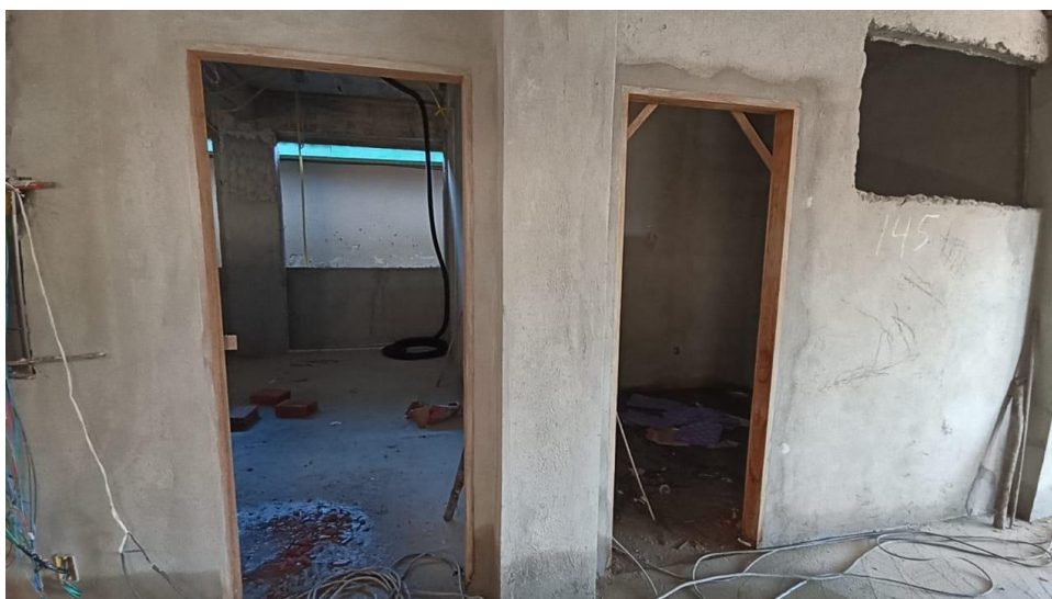
Figura 6 - Detalhe para assentamentos dos batentes das portas
