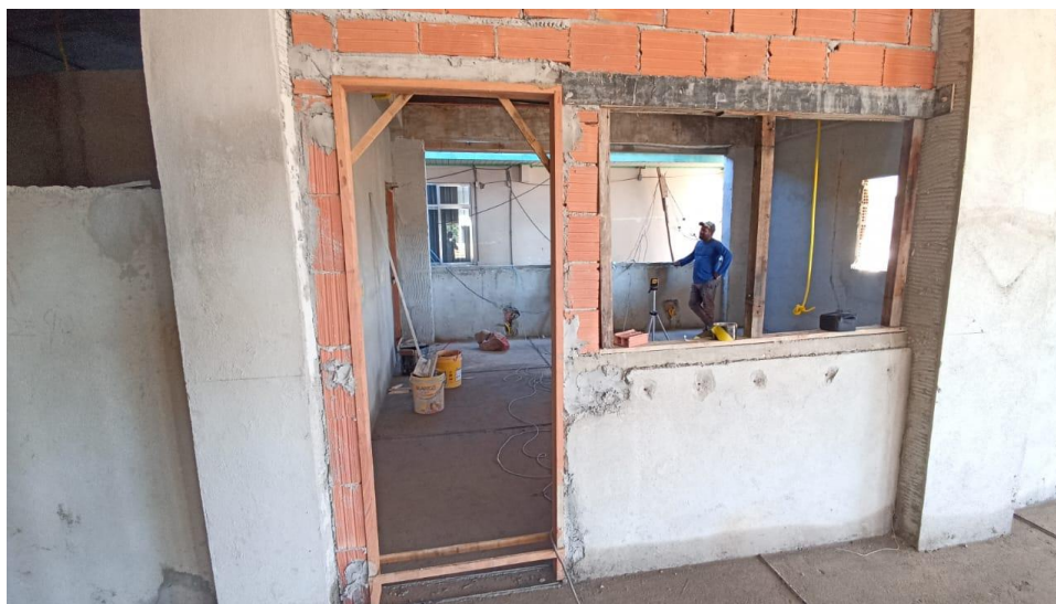
Figura 1 - Detalhe para assentamentos dos batentes das portas
