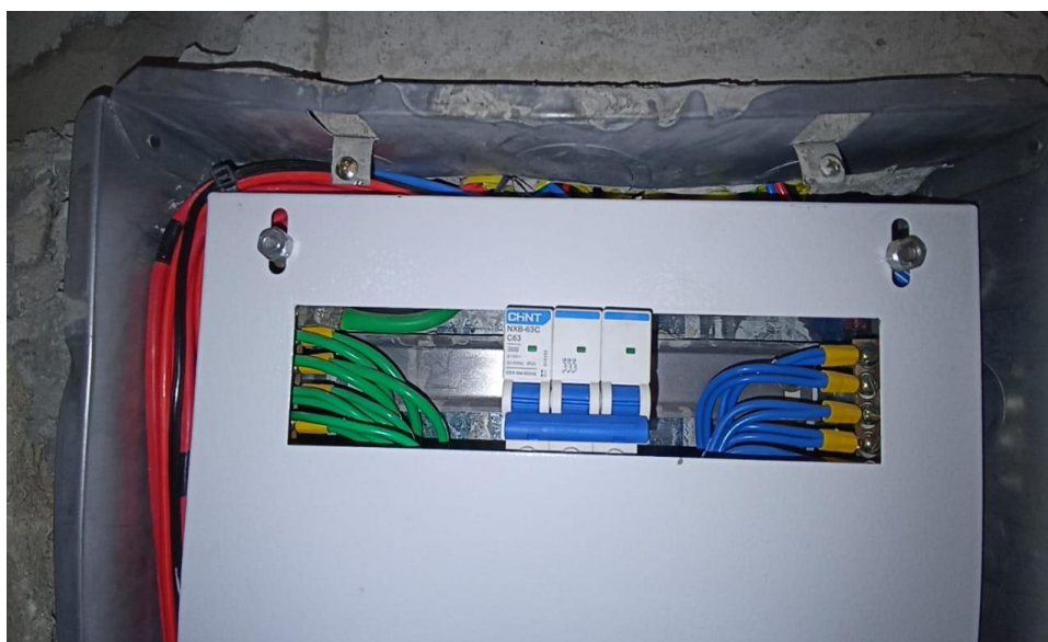
Figura 9 - Detalhe para disjuntores instalados na caixa de distribuição
