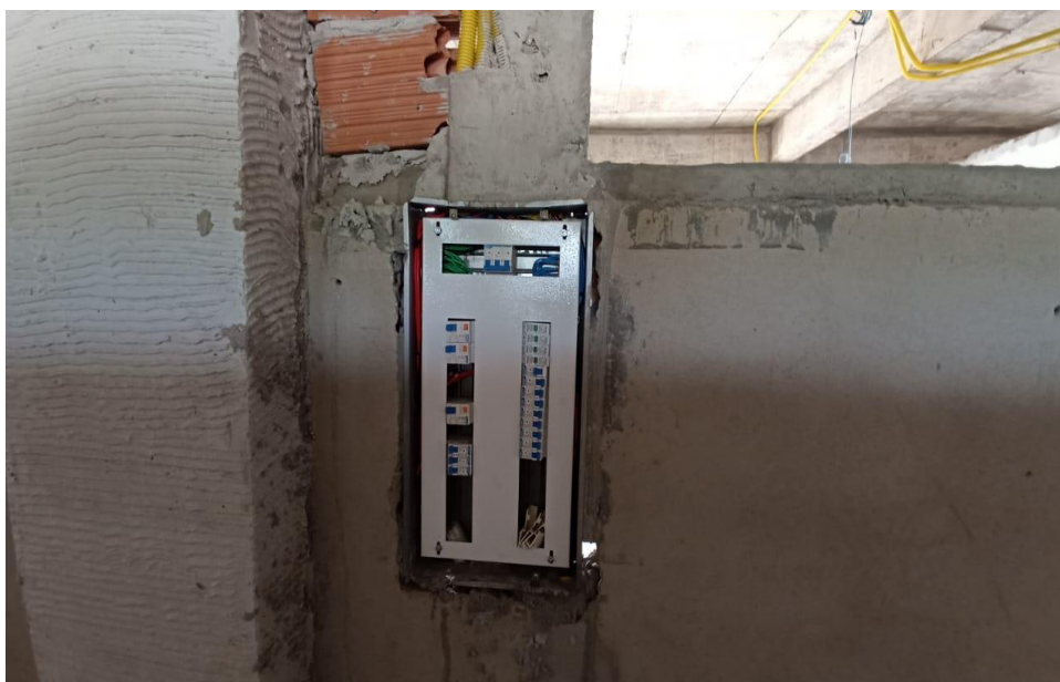
Figura 6 - Detalhe para disjuntores instalados na caixa de distribuição
