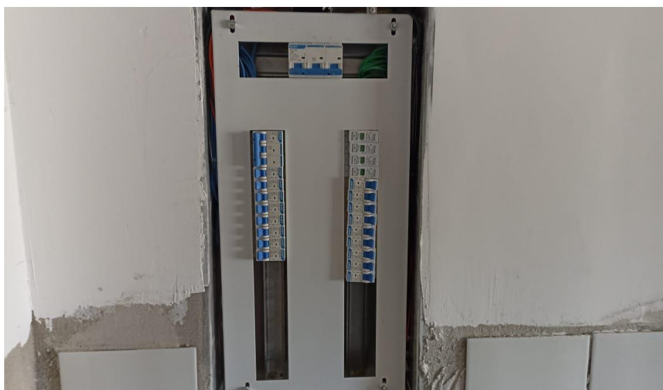
Figura 8 - Detalhe para disjuntores instalados na caixa de distribuição
