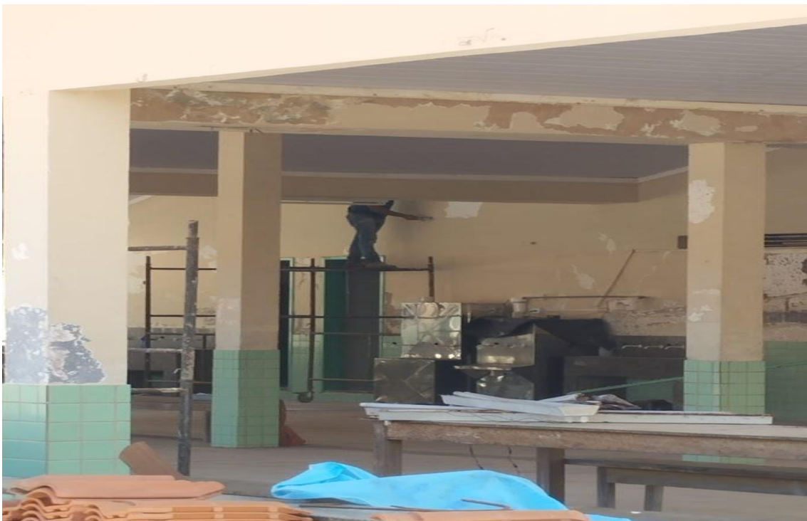
Imagens que registram a situação estrutural da Escola Edson Altoé no início da gestão (janeiro de 2025).
