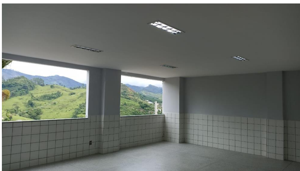
Figura 12 - Detalhe para pintura das paredes e forro de gesso das paredes parte interna
