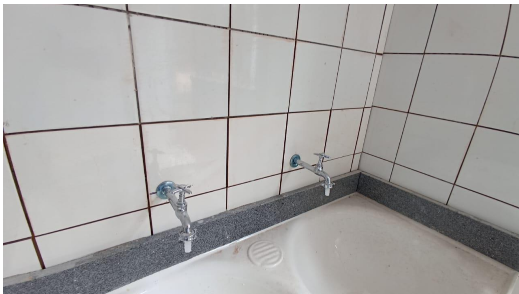
Figura 53 - Detalhe para torneiras cromada longa – térreo
