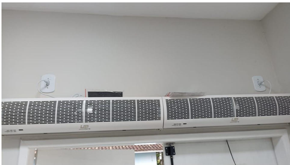
Figura 45 - Detalhe para pontos padrão para tomadas ar condicionado
