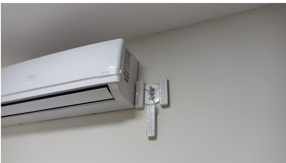
Figura 48 - Detalhe para ponto para iluminação de emergência
