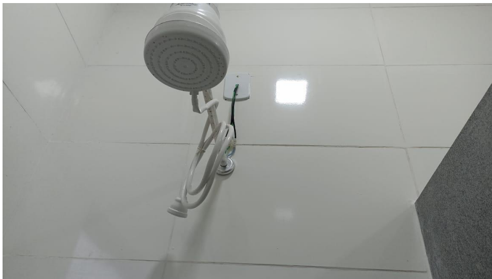
Figura 42 - Detalhe para ponto tomada de chuveiro
