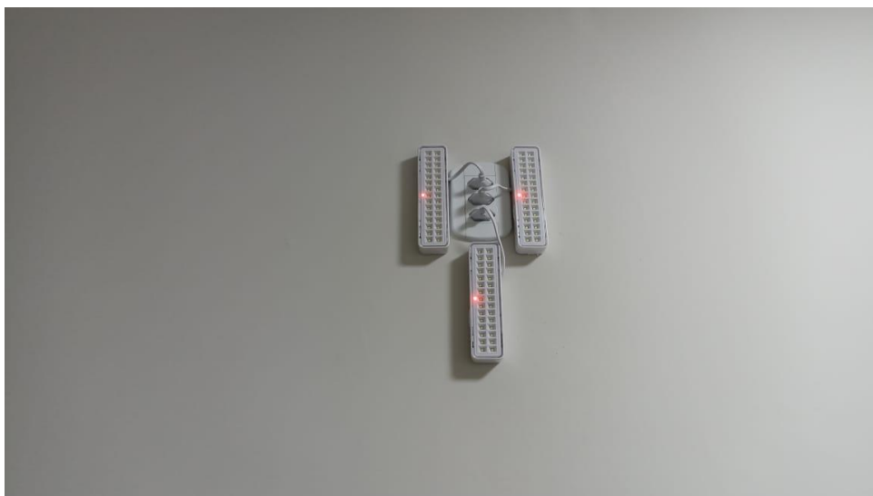
Figura 47 - Detalhe para ponto para iluminação de emergência
