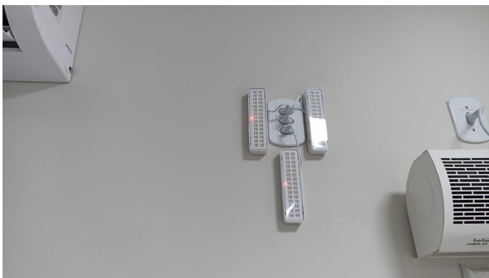
Figura 46 - Detalhe para ponto para iluminação de emergência
