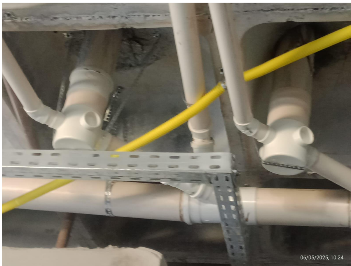
FOTO 03 – Eletrocalhas instaladas, caixas sifonadas, tubulação com diâmetro de 50mm e 100mm.
