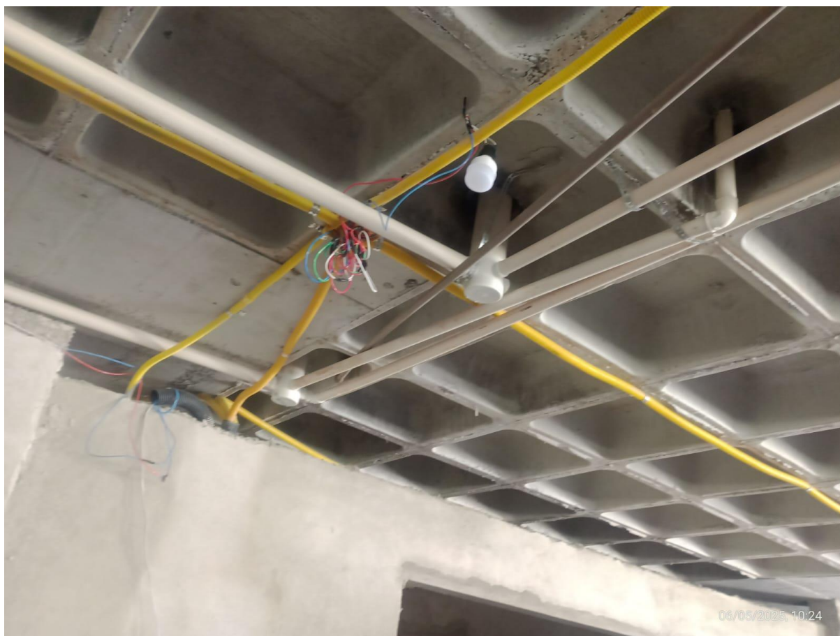
FOTO 02 – Instalações de esgoto, hidráulica e elétrica.
