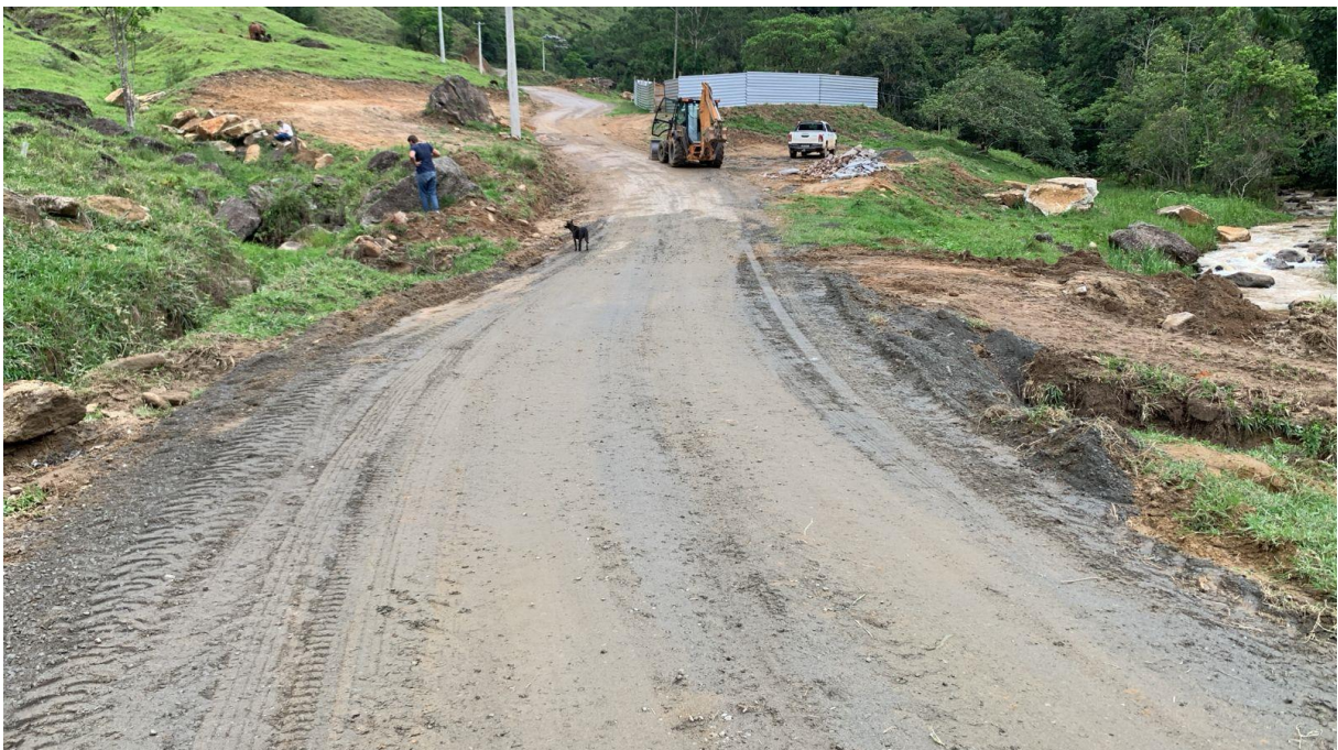
Imagem 07: Detalhe para a execução e compactação de base para pavimentação de brita graduada simples no trecho de assentamento dos tubos de concreto para redes coletoras de águas pluviais de diâmetro de 800 mm.
