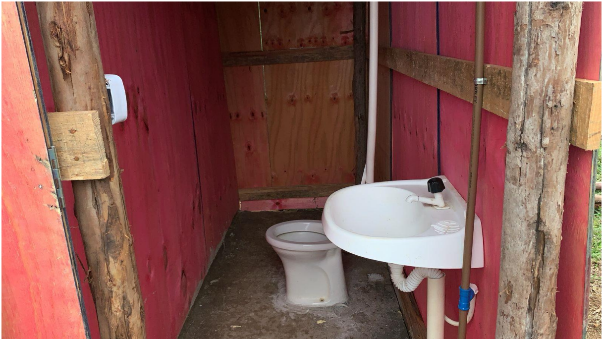
Imagem 04: Detalhe para a execução de sanitário e vestiário, rede de água e rede de esgoto.
