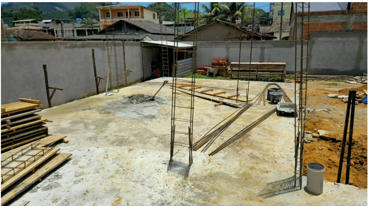
Imagem 05: Detalhe para a execução da etapa de fundação da área de ampliação.
