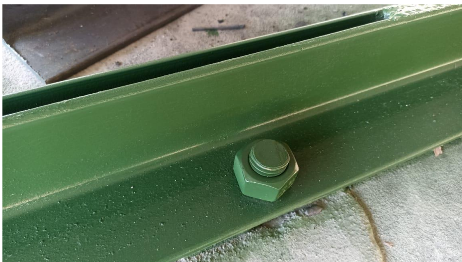
Figura 6 – Detalhe para barra rosca fixada com polca na base das estruturas metálicas (torres)
