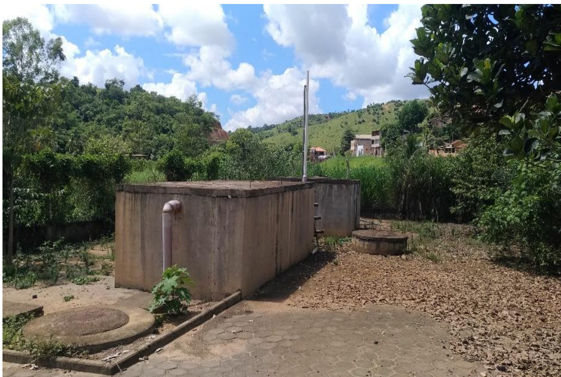
Figura 31: Tratamento biológico (tanque séptico)
