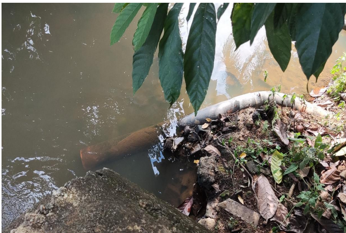
Figura 39: Lançamento de efluente tratado no corpo receptor
