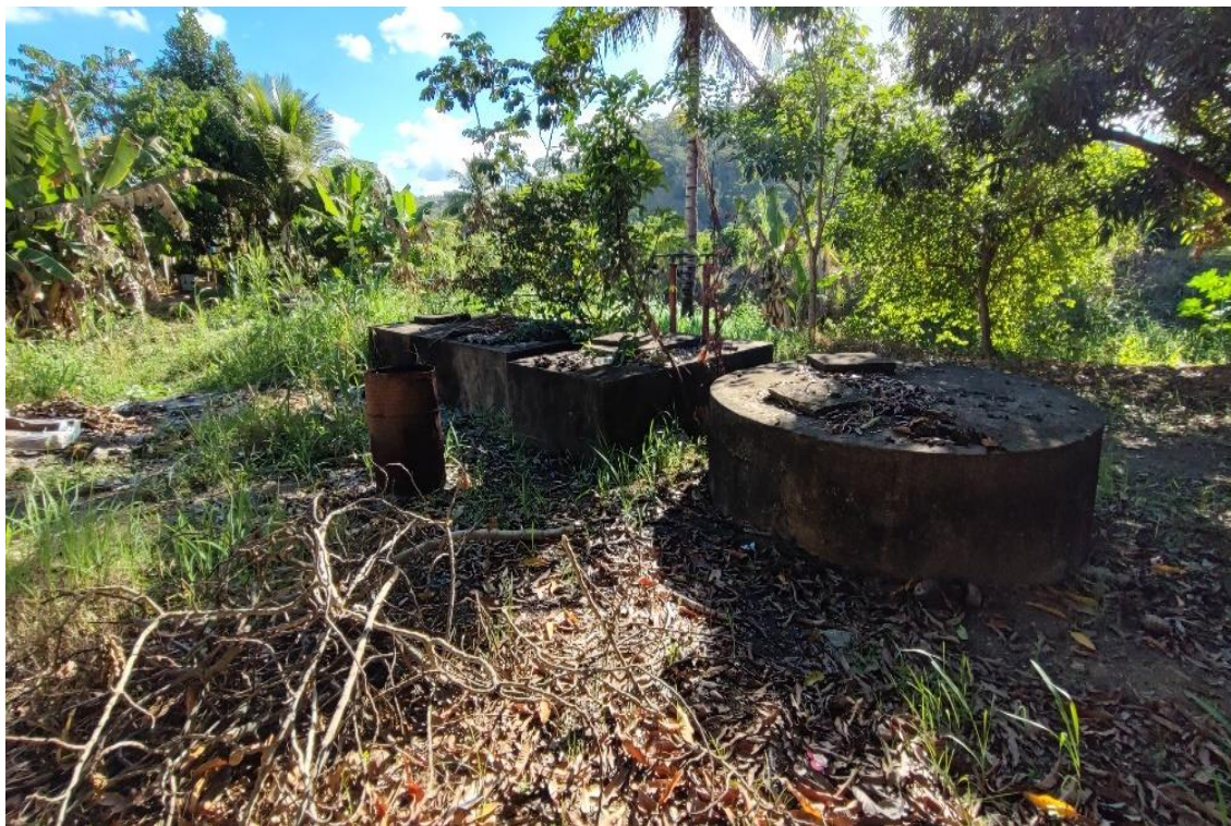
Figura 34: Tratamento biológico (tanque séptico + filtro anaeróbio)
