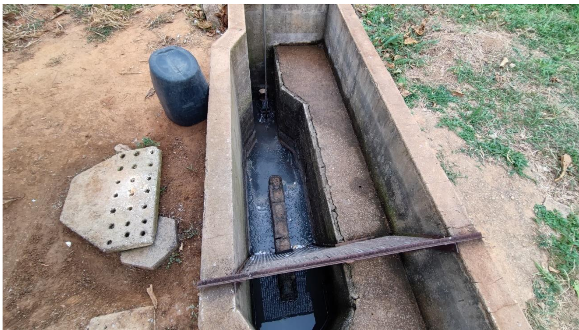
Figura 18: Tratamento preliminar (gradeamento + caixa de areia)
