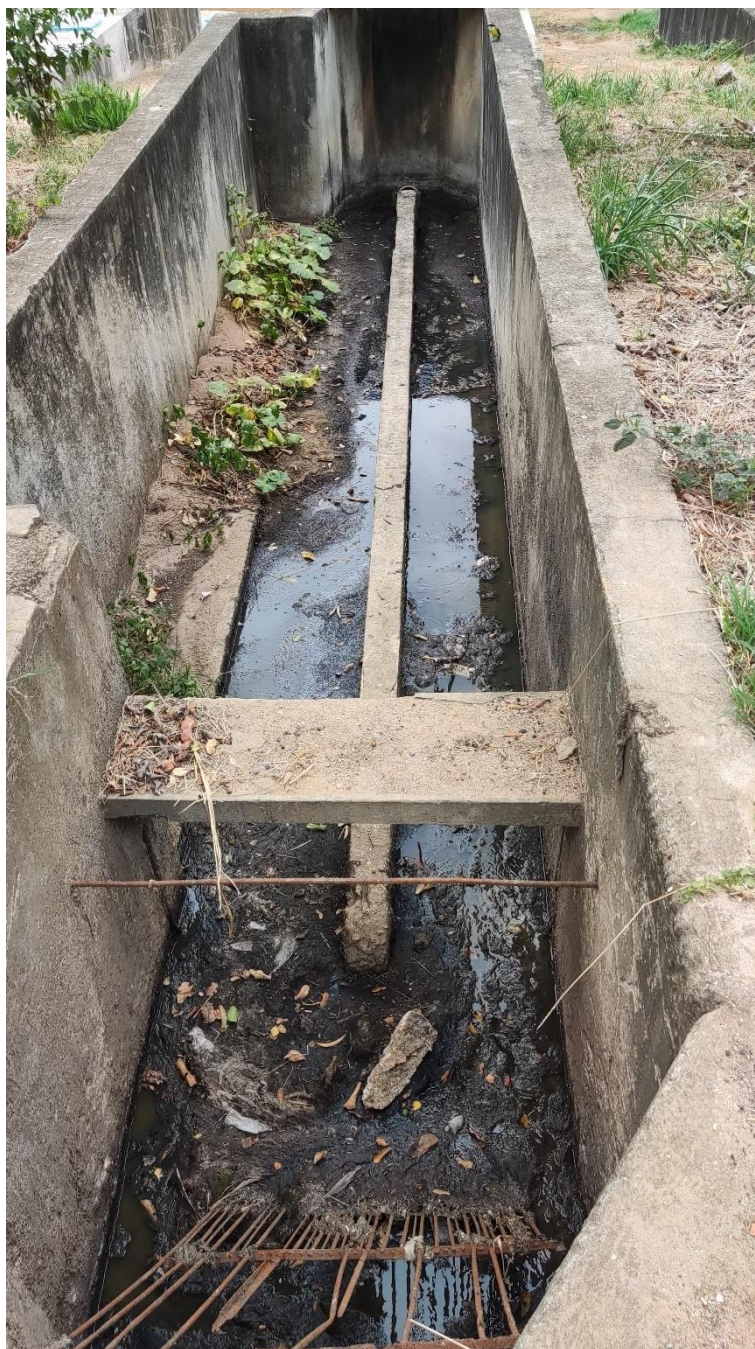
Figura 08: Tratamento preliminar (gradeamento + caixa de areia)
