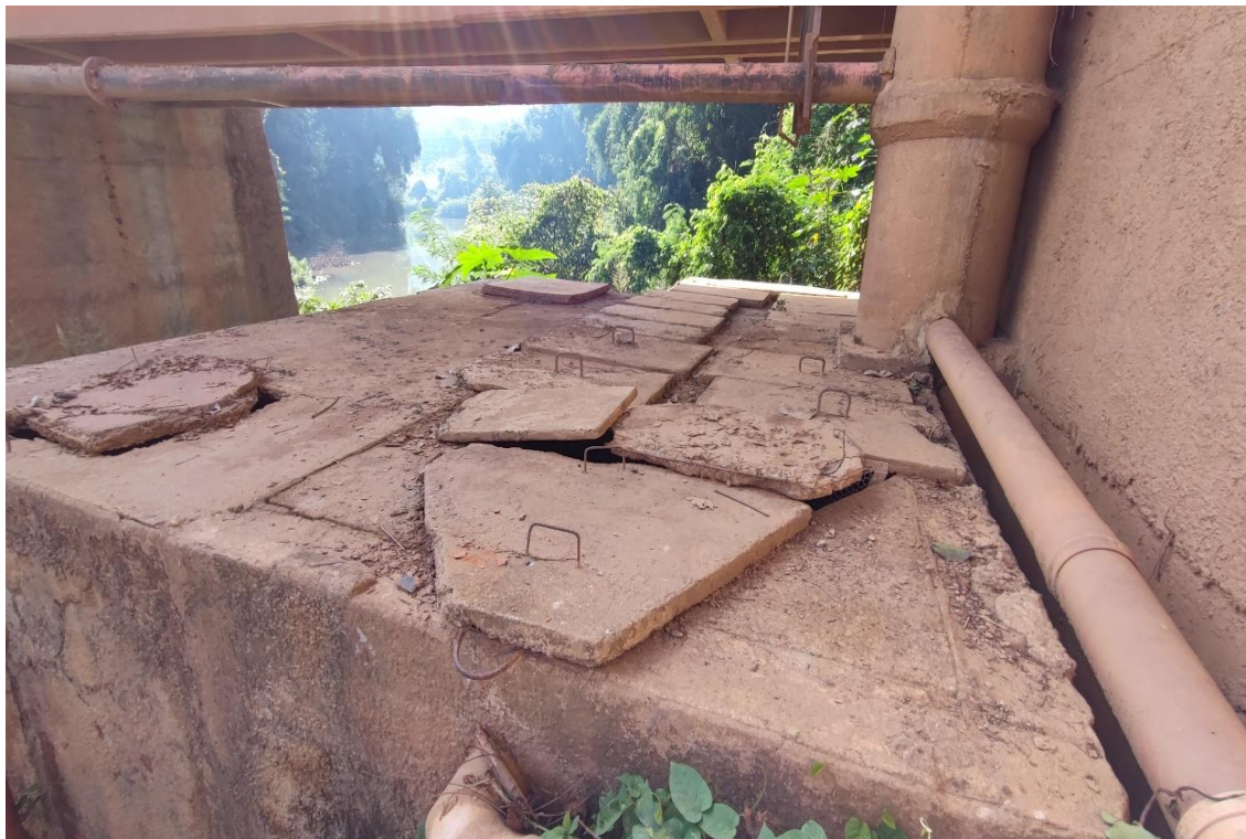
Figura 40: Tratamento preliminar (gradeamento + caixa de areia)
