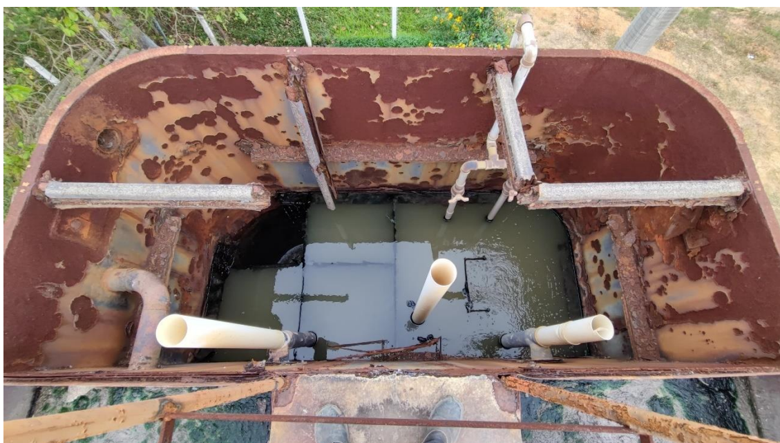
Figura 25: Tratamento biológico (biofiltro aerado submerso + filtro terciário)
