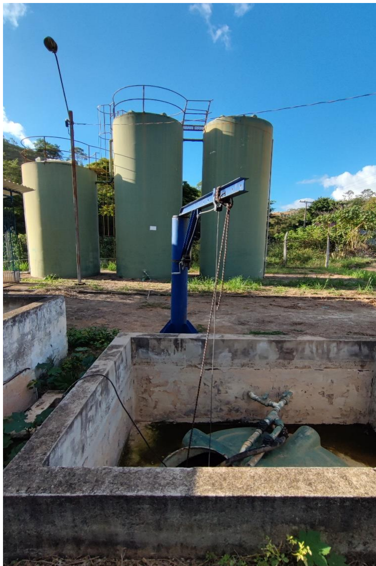
Figura 17: Tratamento biológico (filtro anaeróbio + biofiltro aerado submerso + decantador secundário)
