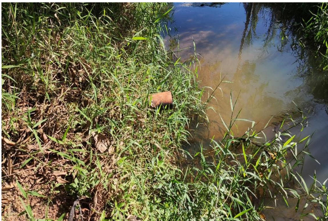
Figura 35: Lançamento de efluente tratado no corpo receptor
