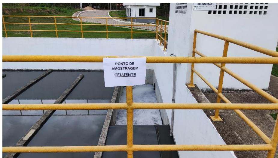
Figura 02: Ponto de amostragem do efluente
