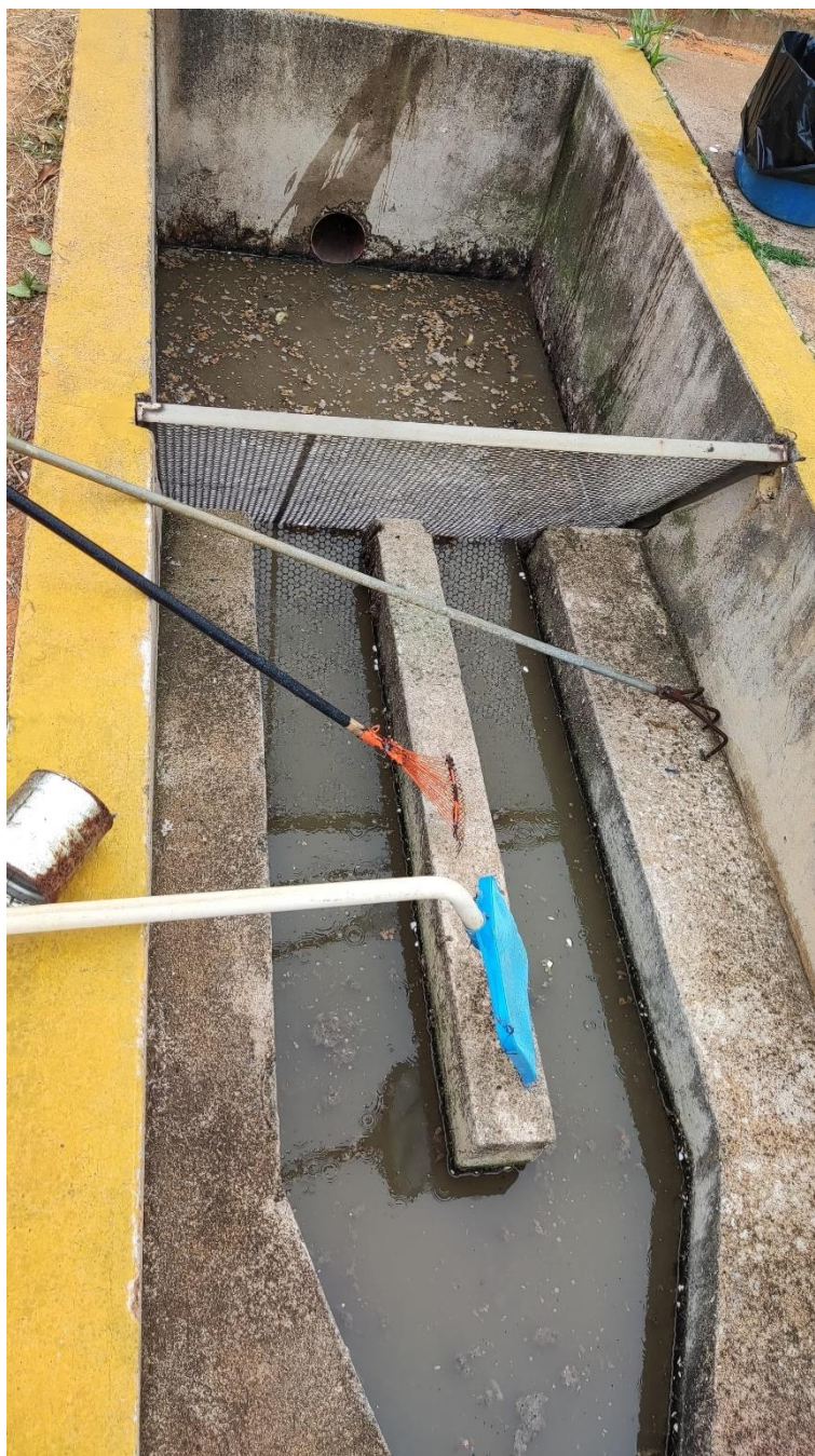
Figura 26: Tratamento preliminar (gradeamento + caixa de areia)
