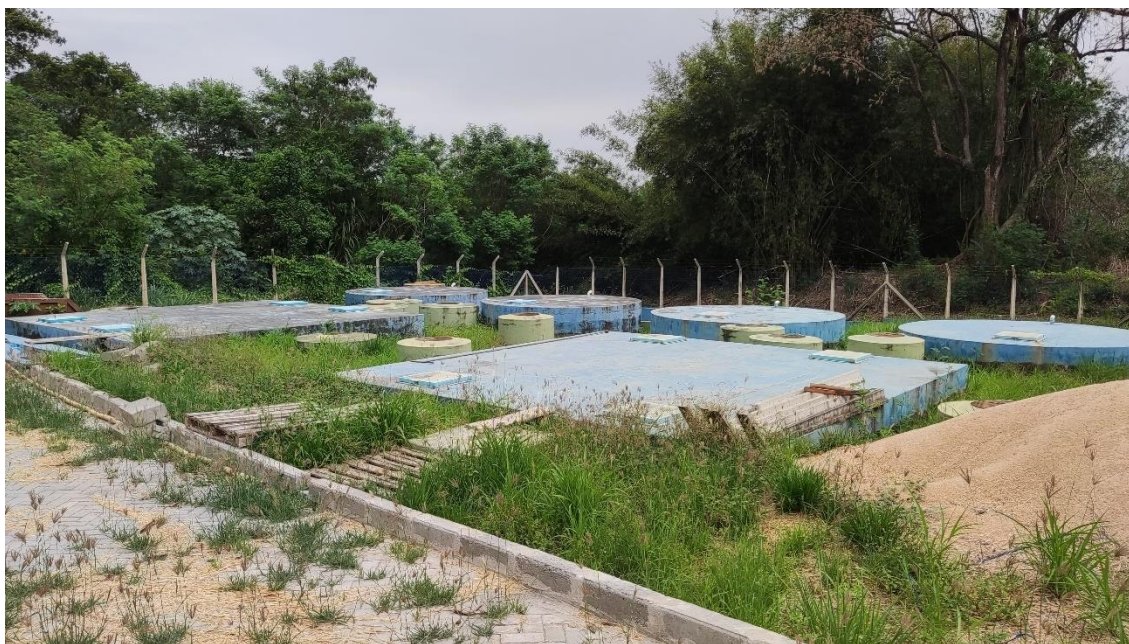
Figura 13: Tratamento biológico (tanque séptico + filtro anaeróbio)
