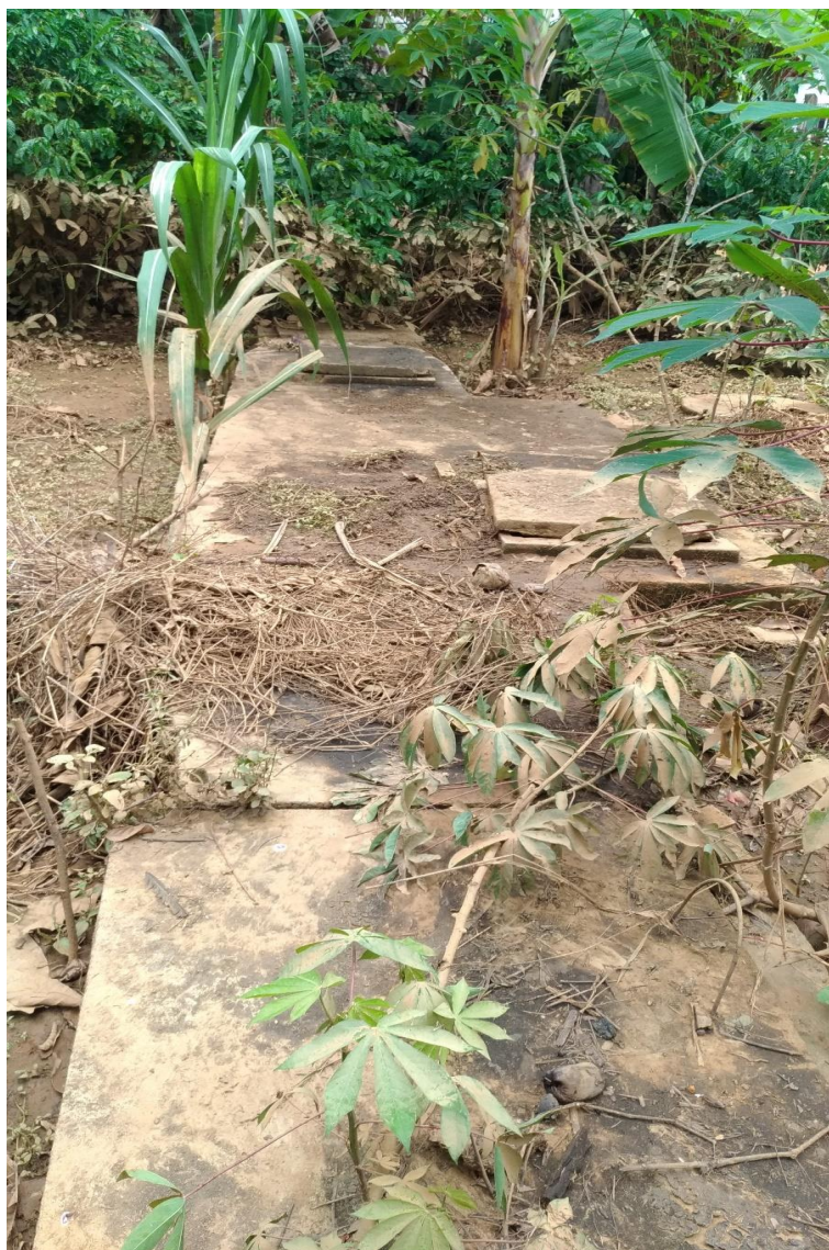
Figura 36: Tratamento preliminar (gradeamento + caixa de areia)
