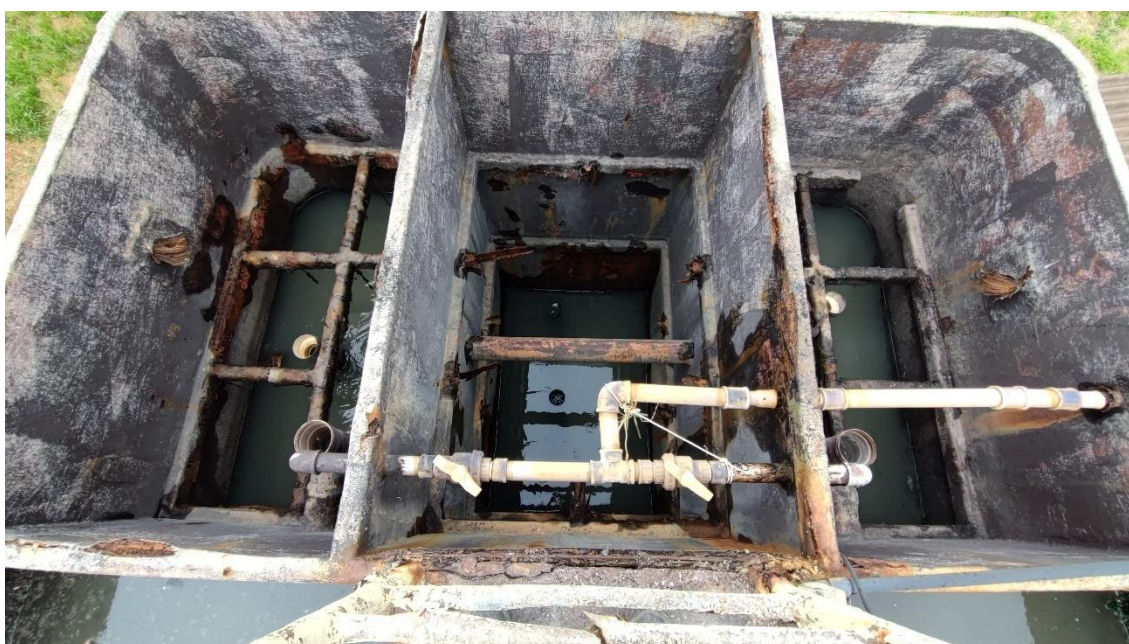
Figura 21: Tratamento biológico (biofiltro aerado submerso + filtro terciário)
