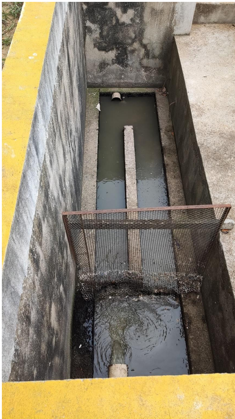
Figura 23: Tratamento preliminar (gradeamento + caixa de areia)
