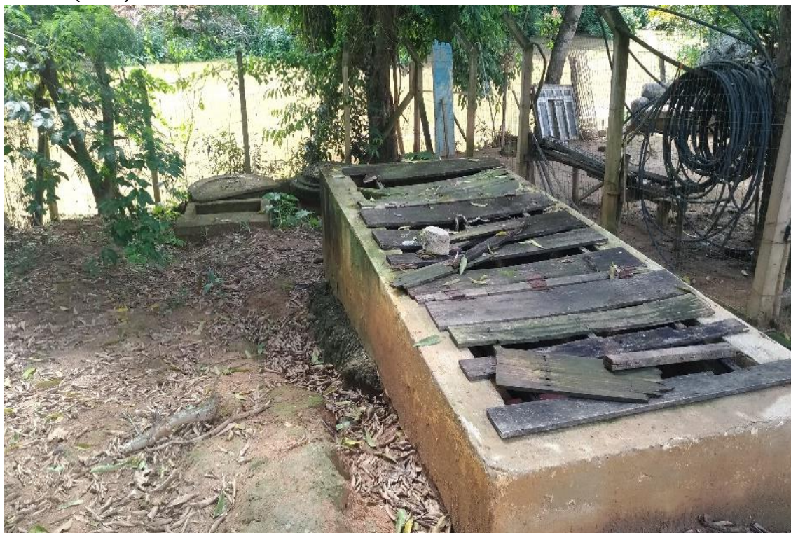
Figura 30: Tratamento preliminar (gradeamento + caixa de areia)
