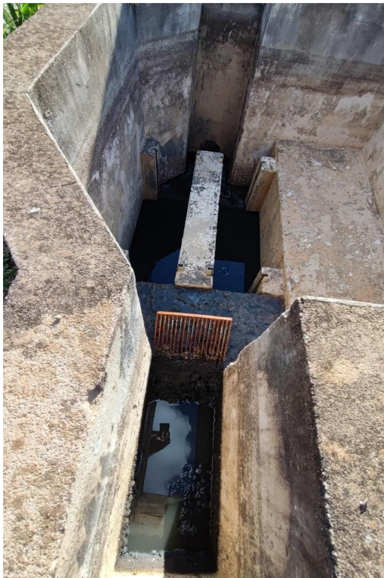
Figura 15: Tratamento preliminar (gradeamento + caixa de areia)
