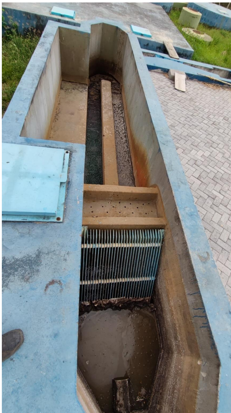
Figura 12: Tratamento preliminar (gradeamento + caixa de areia)
