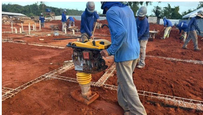
Compactação mecânica de solo para execução de radier, piso de concreto ou laje sobre solo, com compactador de solos tipo placa vibratória. Af_09/2021
