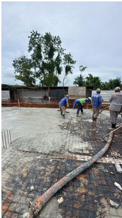
Fornecimento e aplicação de concreto usinado fck=30 mpa - considerando lançamento manual para infra-estrutura (5% de perdas já incluído no custo)
