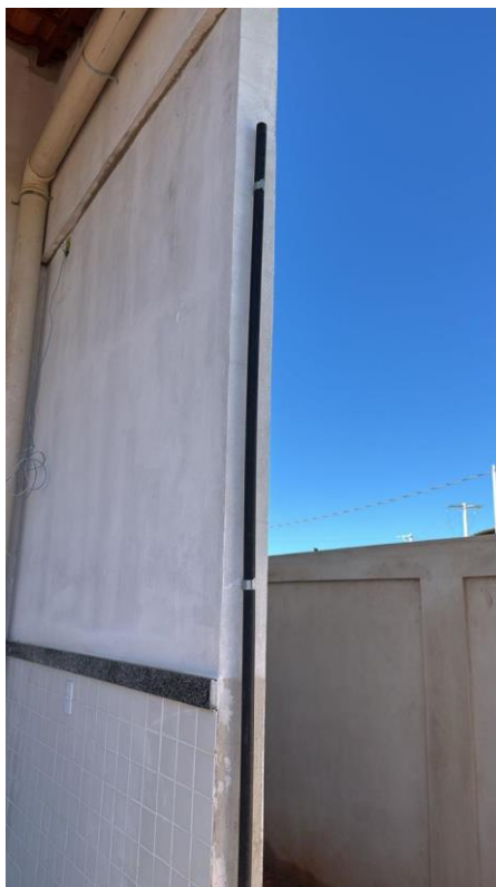
Figura 30: ELETRODUTO APARENTE DE PVC RÍGIDO ROSCÁVEL DIÂMETRO 1", INCLUSIVE ABRAÇADEIRA DE FIXAÇÃO
