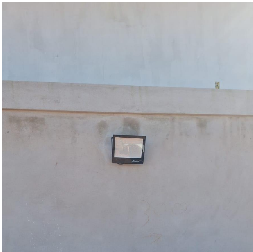
Figura 5: FORNECIMENTO E INSTALAÇÃO DE HOLOFOTE REFLETOR DE LED LINEAR 200W IP68 BRANCO BIVOLT DUPLO
