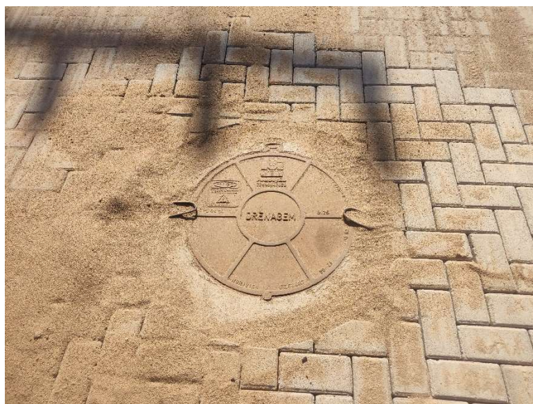
CHAMINÉ DOS POÇOS DE VISITA - CPV 01
