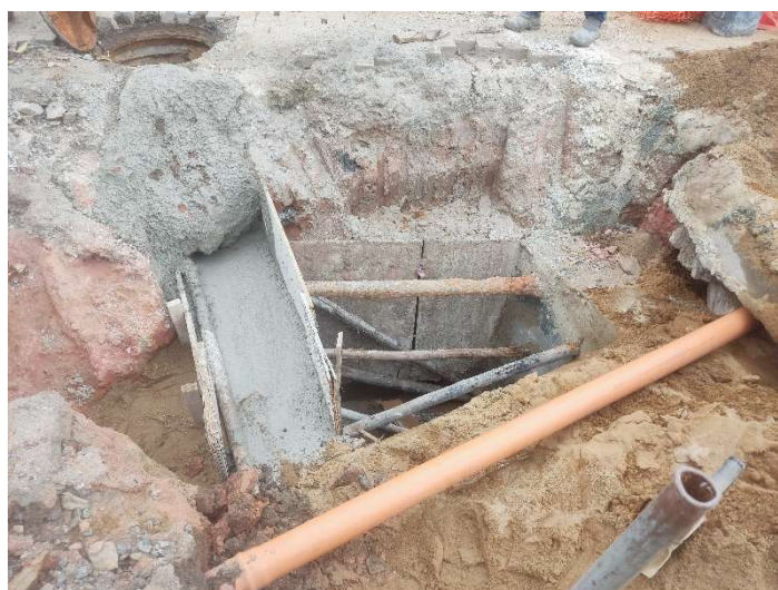
POÇO DE VISITA - PVI 05
