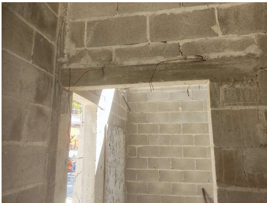
VERGA/CONTRAVERGA RETA DE CONCRETO ARMADO 10 X 5 CM, FCK = 15 MPA, INCLUSIVE FORMA, ARMAÇÃO E DESFORMA
