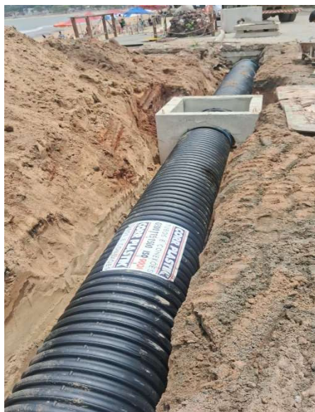
CAIXA DE LIGAÇÃO E PASSAGEM
