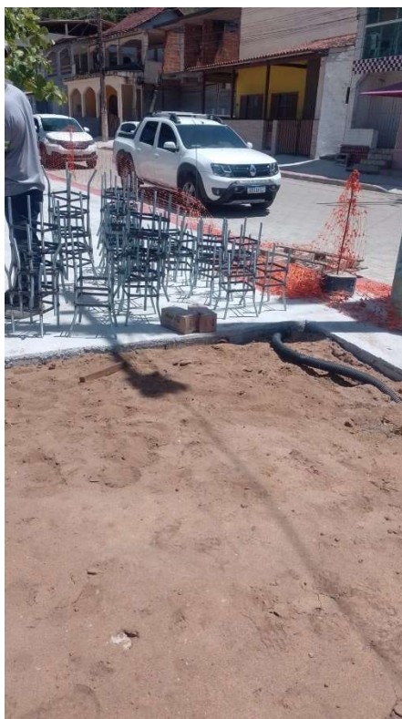
ELETRODUTO PEAD, COR PRETA, DIAM. 1.1/2"
