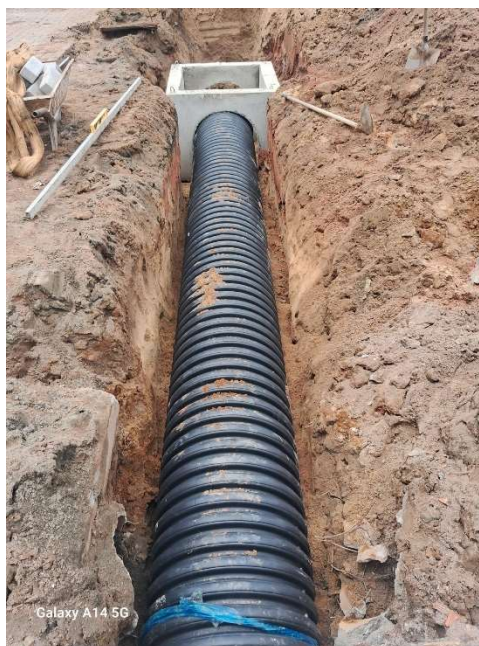
CAIXA DE LIGAÇÃO E PASSAGEM
