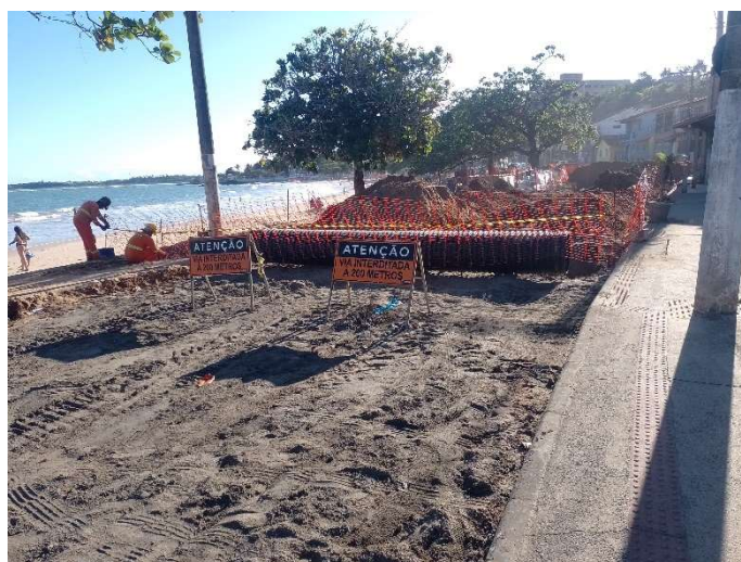
SINALIZAÇÃO VERTICAL COM CHAPA REVESTIDA EM PELÍCULA
