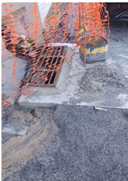
CAIXA DE LIGAÇÃO E PASSAGEM
