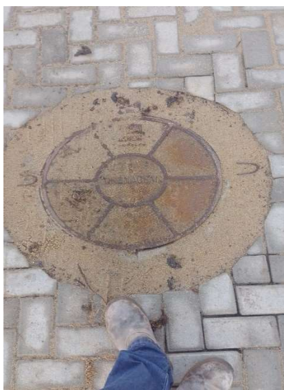
CHAMINÉ DOS POÇOS DE VISITA - CPV 01
