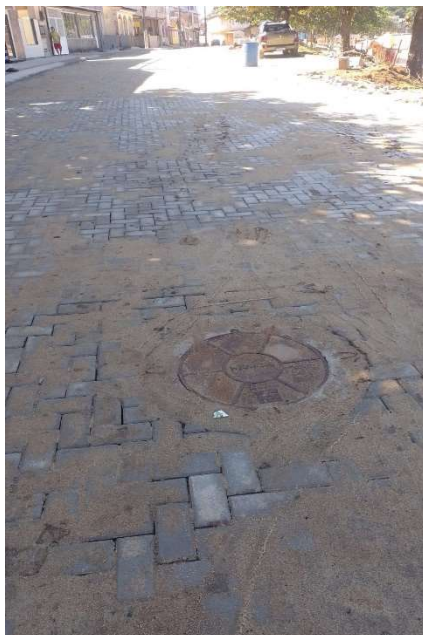
CHAMINÉ DOS POÇOS DE VISITA - CPV 01
