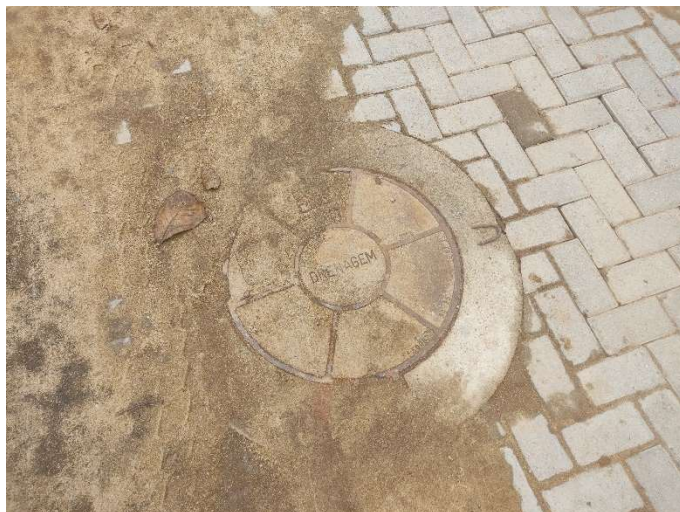
CHAMINÉ POÇO DE VISITA – CPV 01
