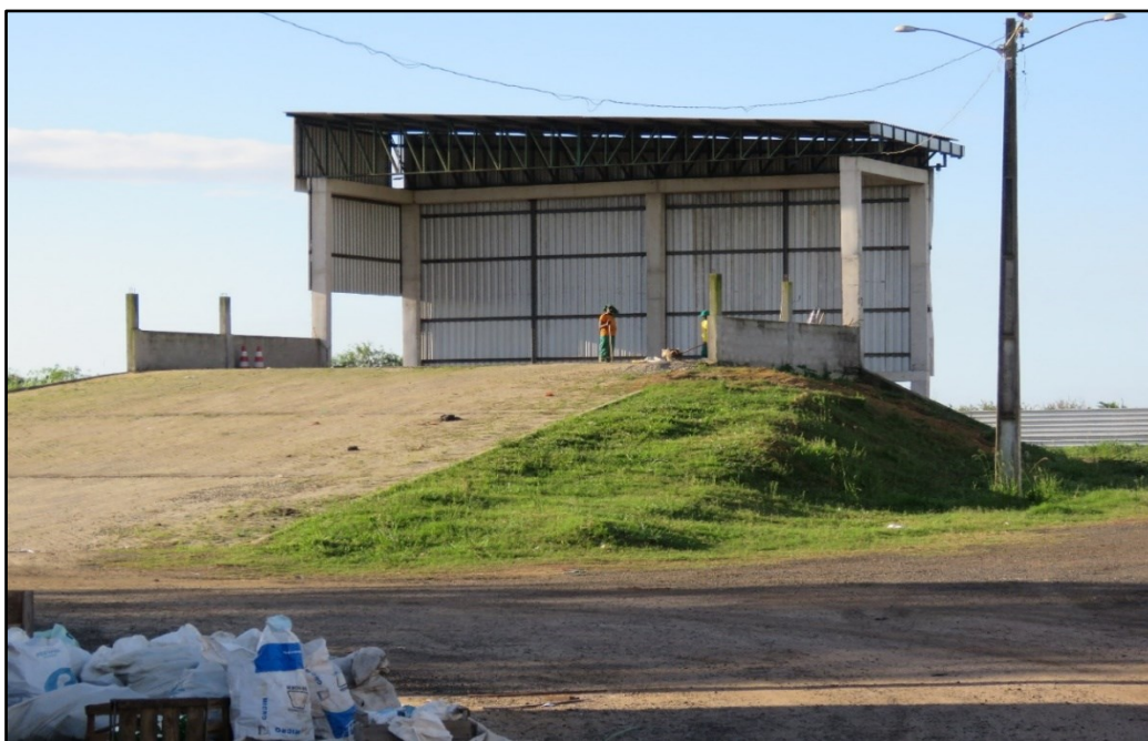
Foto 17 - Transbordo de Pedro Canário. Vê-se a falta de proteção frontal para minimizar chuvas sobre as caixas de depósito temporário de resíduos.
