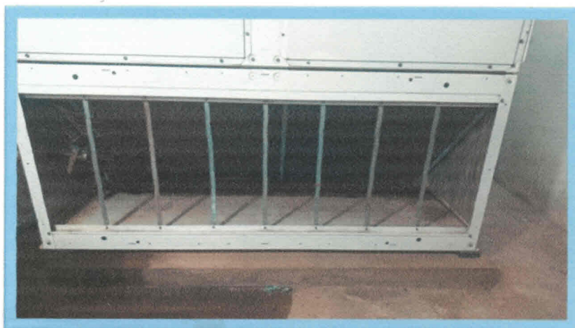
Imagem 1: Local onde se faz necessário os filtros para ar condicionado fancoil G3 G4 – 8 placas.
