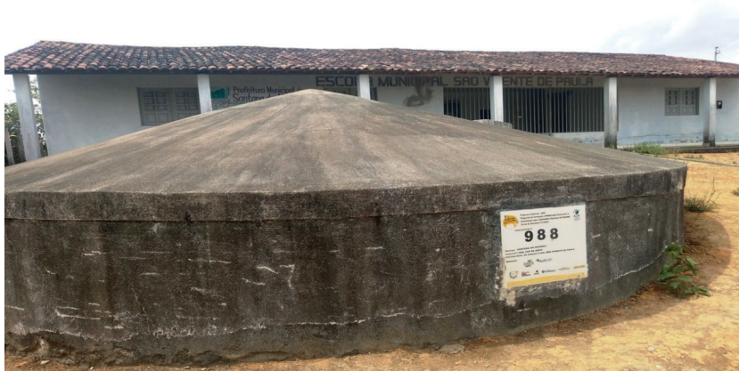
Figura 5 - Cisterna na comunidade Chã de Areia/E.M.E.F São Vicente de Paula.
