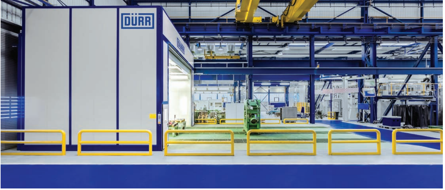
İçeri çekilen teleskopik kabin, boyama tesisinde yükleme ve manevra için alan sağlamaktadır.
