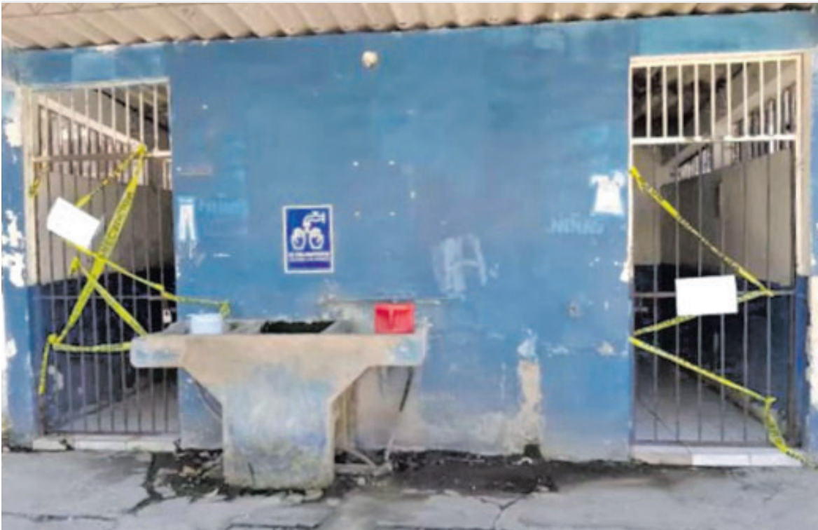
Niños sin acceso a baños en la escuela de Yoloaiquin en Morazán, tras haberse dañado las tuberías.
