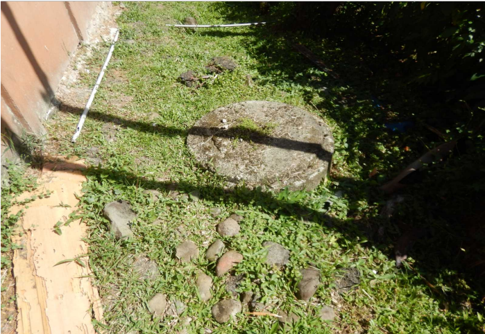
Descripción: Tanque en alcantarilla
