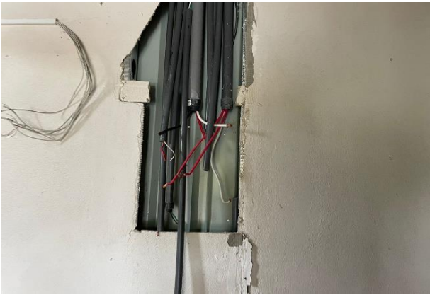
Instalación eléctrica, cableado expuesto, no hay centro de carga.
